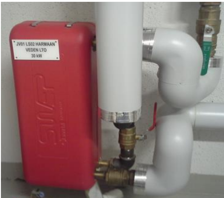
KUVA 7 Käyttöveden esilämmityksen lämmönsiirrin
