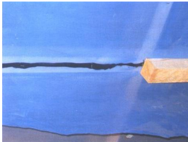
Kuva 14. Ilman- ja höyrynsulun tiivistäminen puristusliitoksella ja kittauksella. Rakenteesta puuttuu vielä osin liitoksen yhteenpuristava koolaus [4, s. 154].
