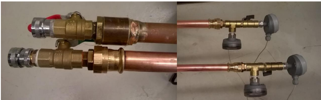
KUVA 11 Cu28- ja Cu28ju-testausputken liitosten eroavaisuudet sekä paine- ja lämpötila-antureiden asennus testausputkiin
