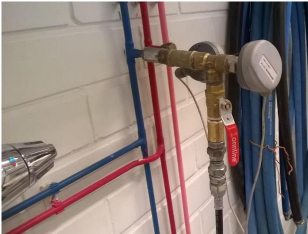
KUVA 16 Paine ja lämpötila-anturi, sulkuventtiili ja sekä koepainepumpun letku liitettynä kylmävesiverkoston T-haaran tehtyyn kytkentään
