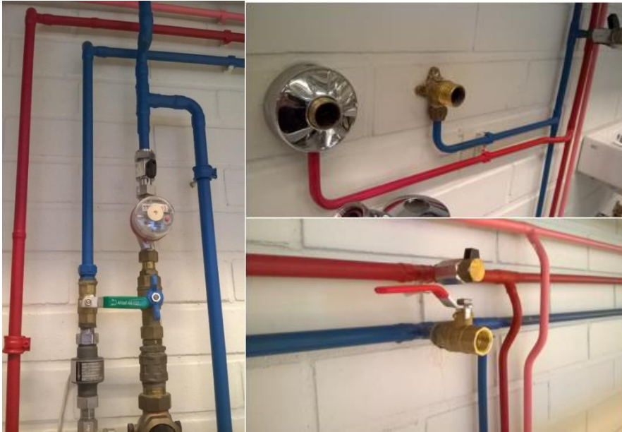
KUVA 17 Kylmävesiverkoston pääsulkuventtiili, pintakulmaliittimet ja kylmävesiverkoston yläosassa oleva sulkuventtiili
