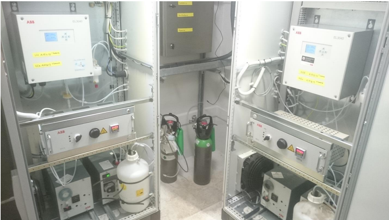
KUVA 9. Instrumenttikopin mittalaitteet (Boliden Kokkola Oy 2017)
