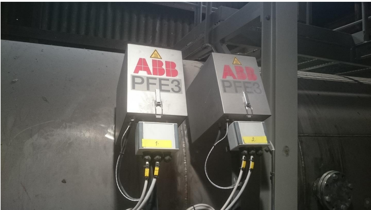
KUVA 8. Häntäkaasuputken mittauspiste (Boliden Kokkola Oy 2017)
