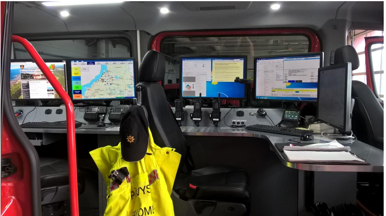
KUVA 4. Tyypillinen suuren pakettiautokokoluokan johtoauton johtotila
