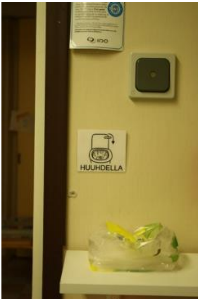
Kuva 8. Kuva wc-pöntön huuhtelemisesta on sijoitettu toiminnan kannalta epäolennaiseen paikkaan.
