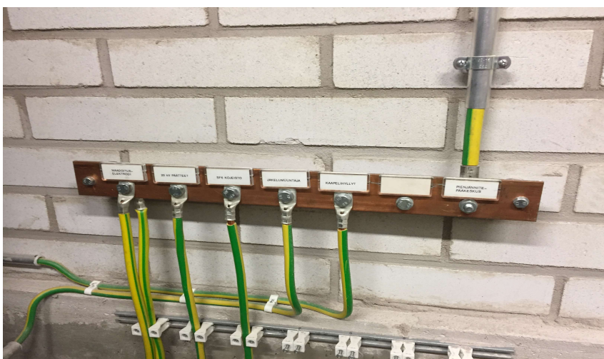
Kuva 6. Muuntamon CT10 päämaadoituskisko MEB01.
