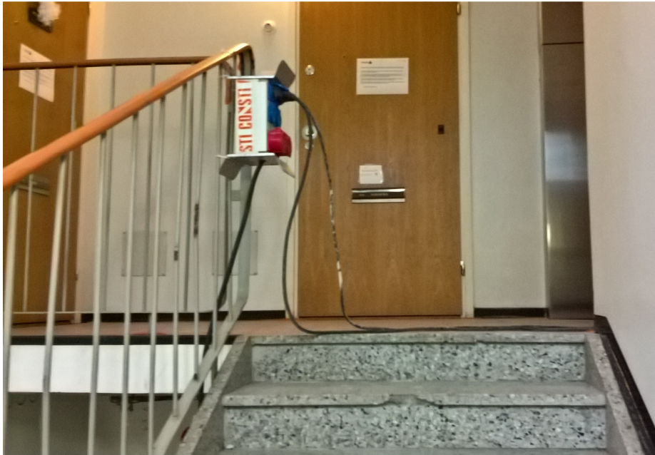
KUVA 6. Sähkökeskuksen sijoitus porrastanteella. 2.8.2017
