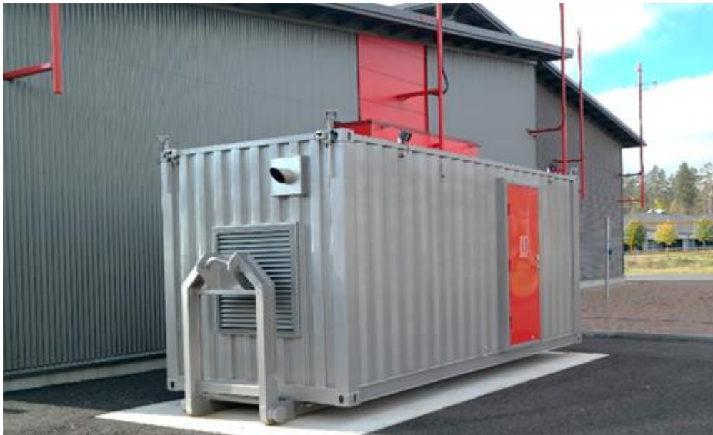
KUVA 3. Konttiin asennettu liikuteltava varavoimajärjestelmä. (Voimalaite Service Oy)
