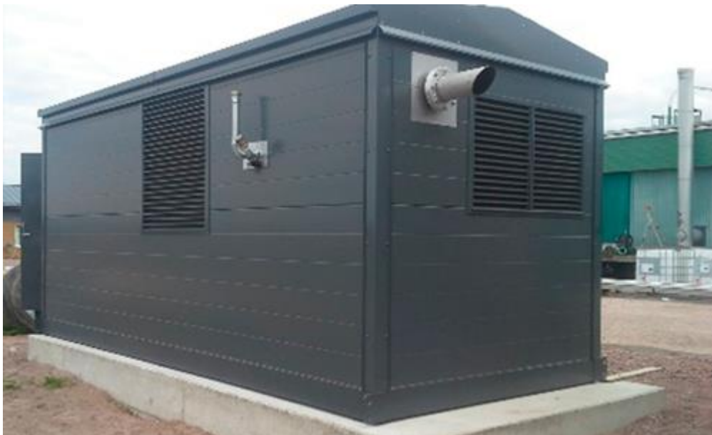
KUVA 4. Sandwich-elementtikonttiin asennettu varavoimajärjestelmä. (Voimalaite Service Oy)
