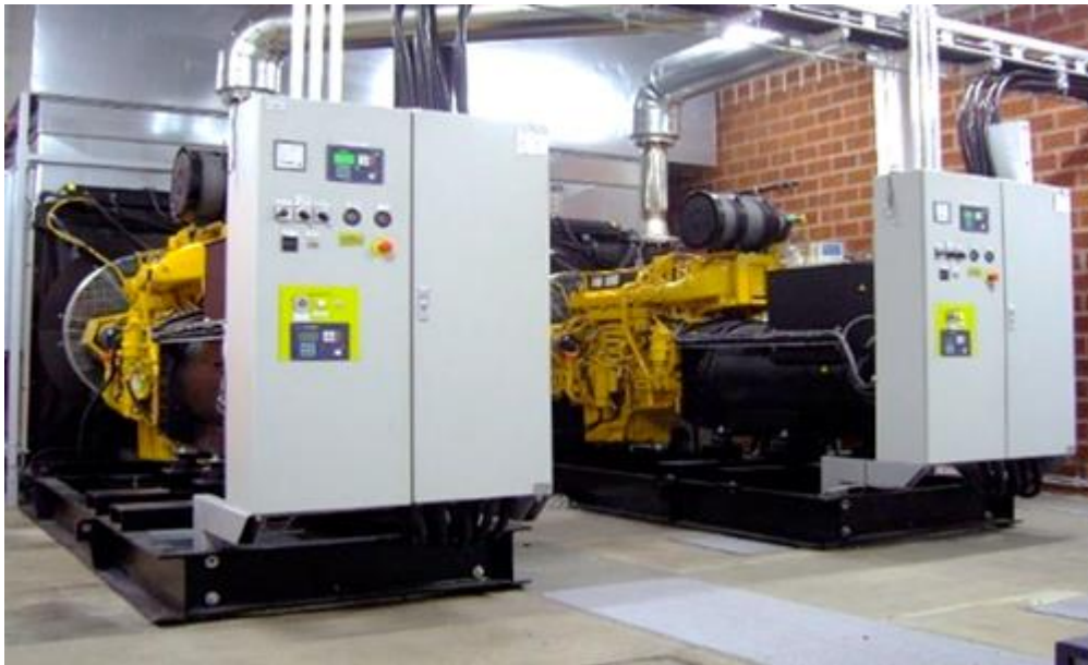
KUVA 1. Konehuoneeseen asennettu avoin järjestelmä. (Voimalaite Service Oy)
