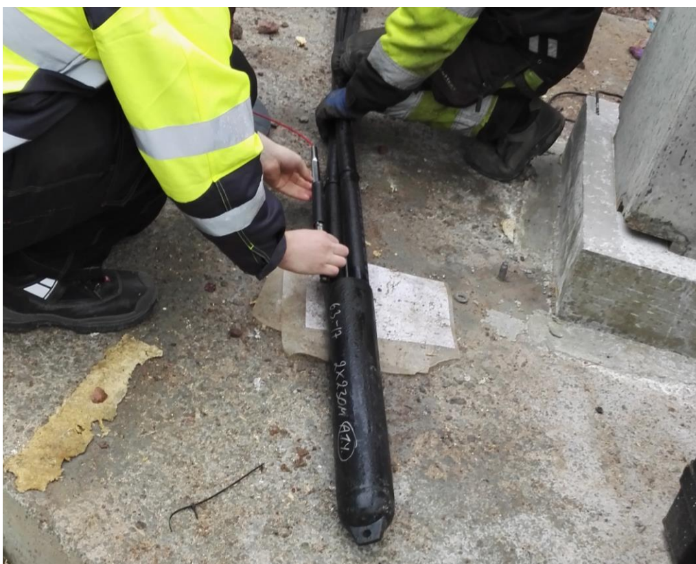
Kuva 13. Keruuputki ja kuitukaapelin kiinnitys.
