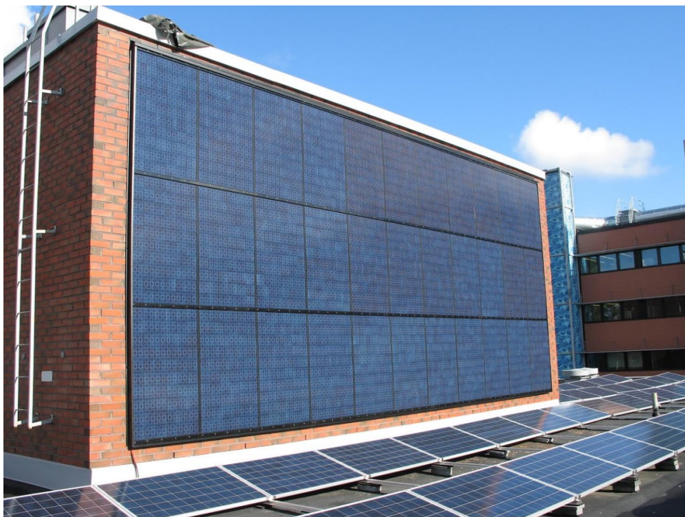
Kuva 2. Kuvassa seinään asennetut aurinkopaneelit Lappeenrannan teknillisellä yliopistolla. ( www.yle.fi )
