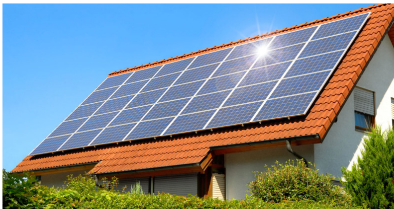
Kuva 3. Aurinkopaneelit asennettuna omakotitalon katolle ( www.solen.fi )
