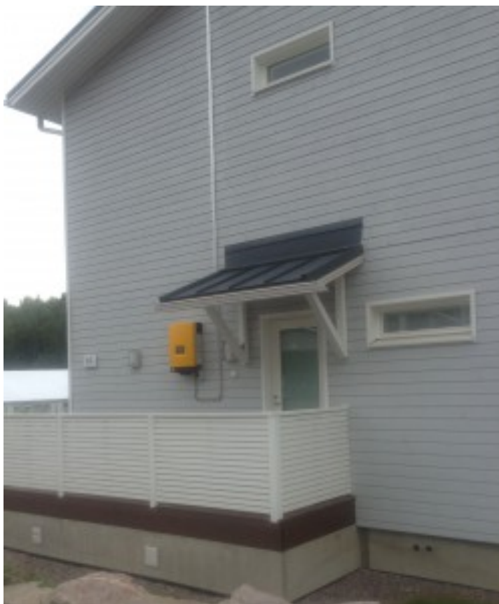
Kuva 10. Verkkoinvertteri asennettuna omakotitalon ulkoseinälle ( www.aurinkovirta.fi )
