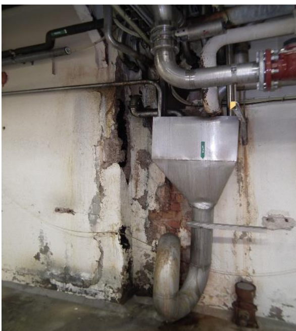
Kuva 5. Korroosioaurio vanhan pesukeskuksen seinässä
