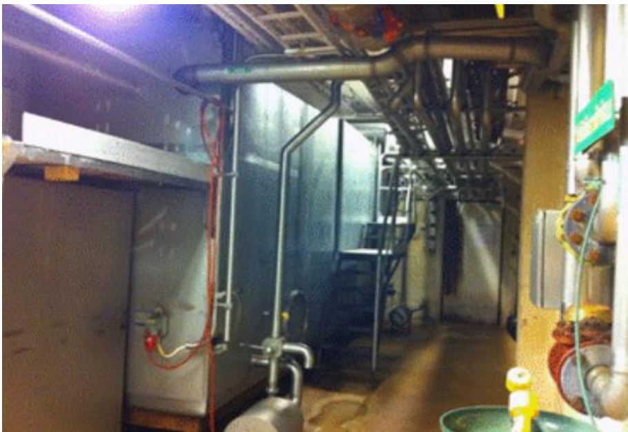
Kuva 7. Vanhan pesukeskuksen pesuliuosäiliöt
