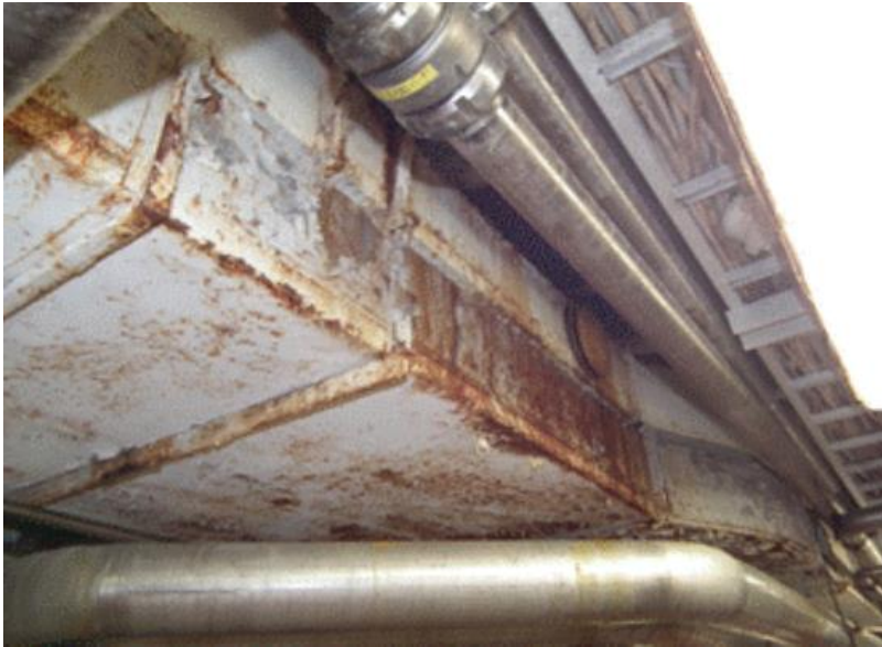
Kuva 6. Ruostetta vanhan pesukeskuksen laitteissa
