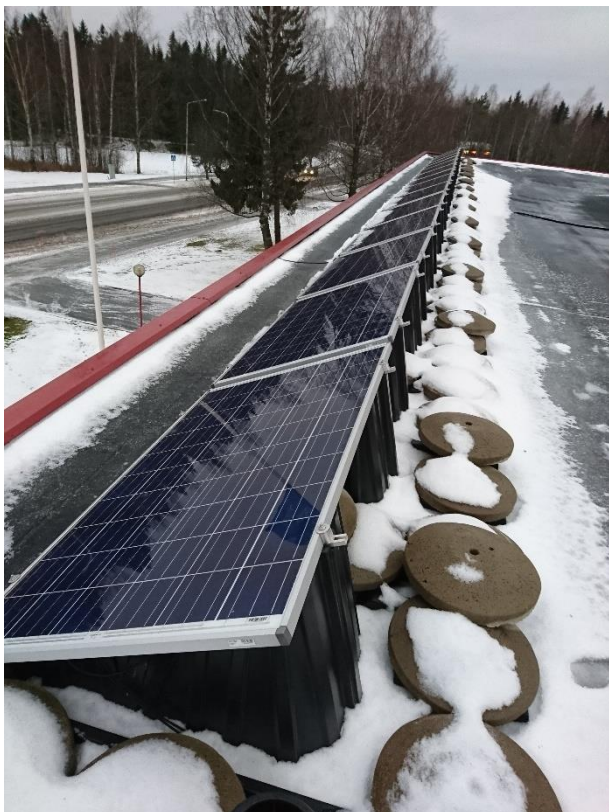
Kuva 5. Vatajankosken Sähkön Kankaanpään toimitilan katolta.
