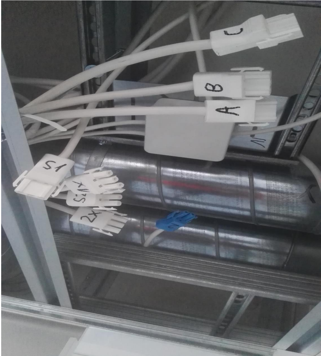
Kuva 4. Valojen kytkentä peruselementissä (C80 tilaelementti Hyökkälän koulu Tuusula)
