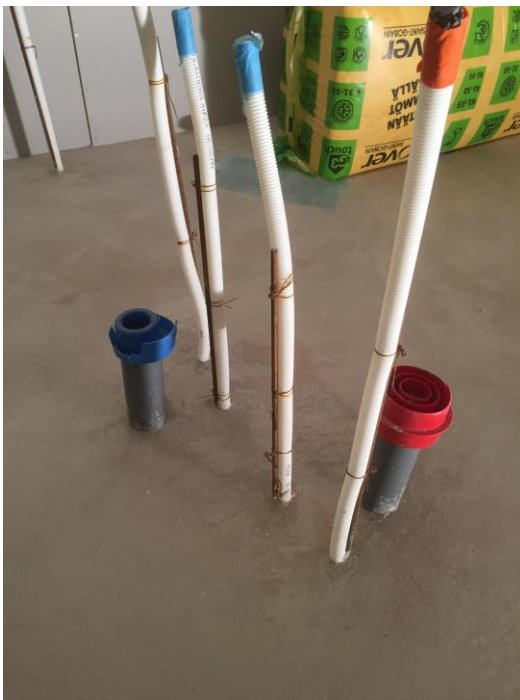
Kuva 20. Tiivistämättömät putkiläpiviennit alapohjassa
