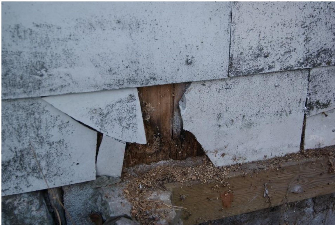
Kuva 7. Osa julkisivuverhoukseen levyistä rikki (Eerola Hanna 2017-02-21)
