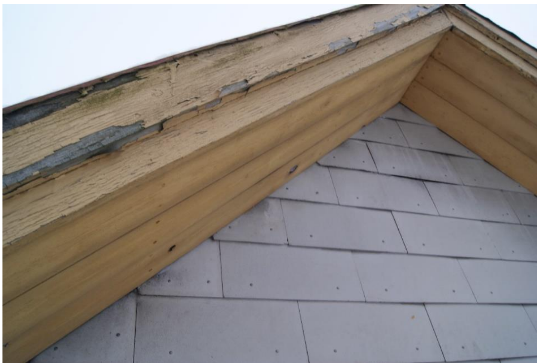
Kuva 8. Rästäslaudoituksessa ei ilmarakoja (Eerola Hanna 2017-02-21)
