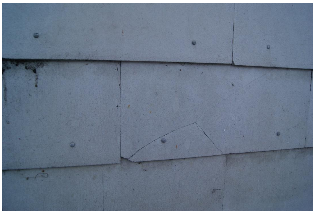
Kuva 4. Julkisivun asbestipitoiset kuitusementtilevyt (Eerola Hanna 2017-01-21)
