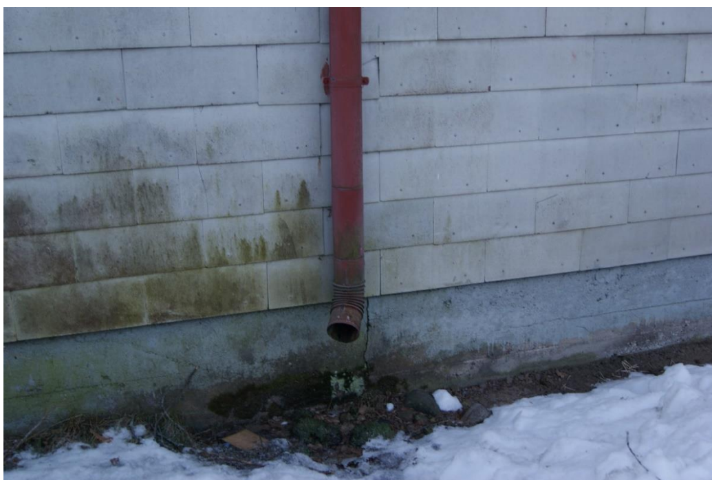
Kuva 16. Syöksytorvesta valuva vesi aiheuttaa betonin halkeilua jäätyessään (Eerola Hanna 2017-02-21)
