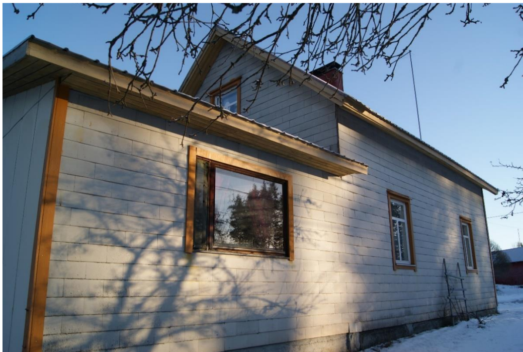
Kuva 15. Toisella puolella taloa ei räystäskouruja tai syöksytorvia (Eerola Hanna 2017-02-21)
