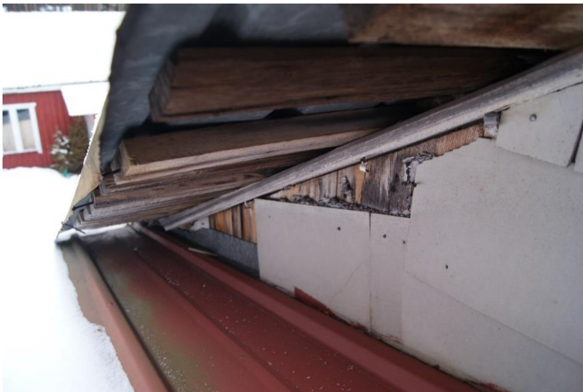
Kuva 19. Julkisivuverhouslevyjä rikki katon ja seinän liitoskohdassa (Eerola Hanna 2017-02-21)
