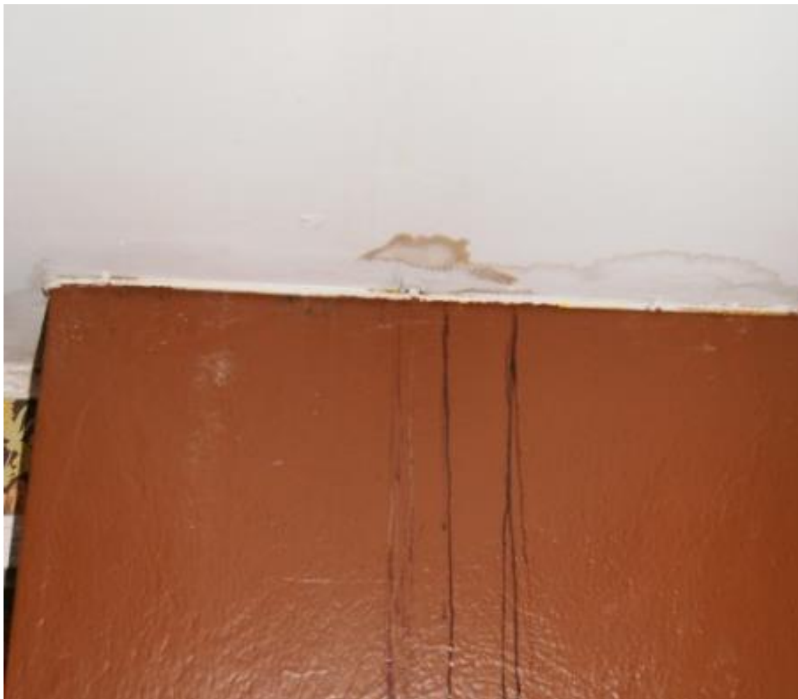
Kuva 10. Savupiipun läpiviennin vuoto (Eerola Hanna 2017-02-21)
