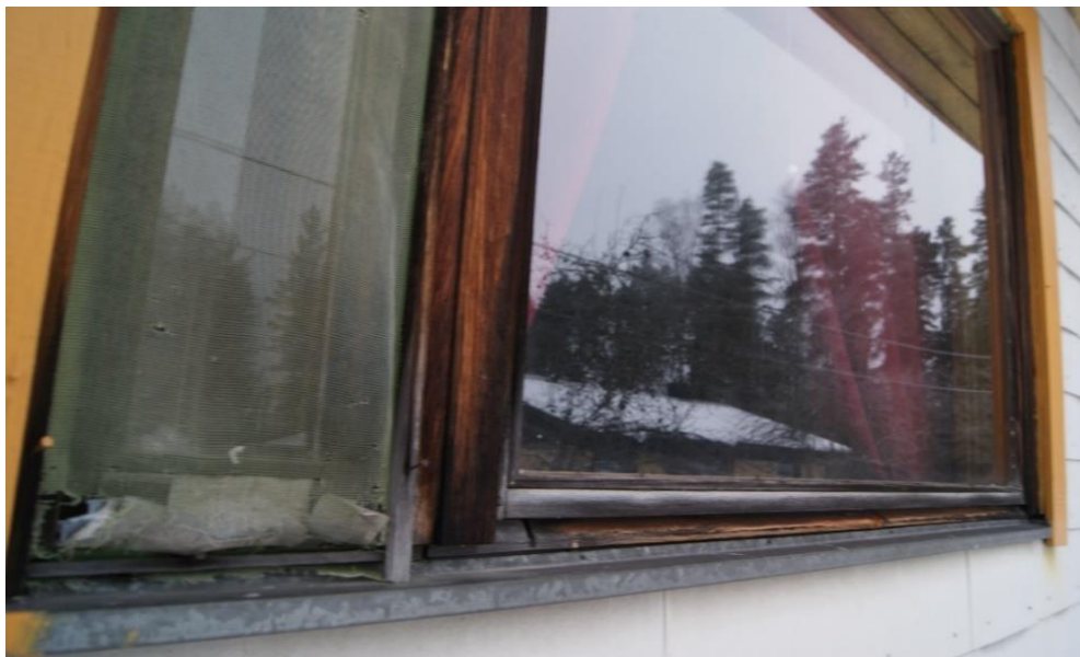
Kuva 17. Vanhat ikkunat ja ikkunapellit (Eerola Hanna 2017-02-21)
