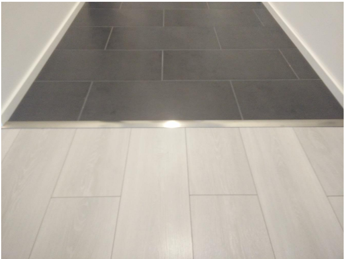
Kuva 1. Kuvassa laminaattilattia yhdistyy laatoitettuun lattiaan.
