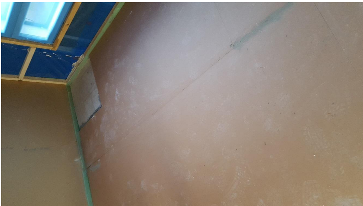
Kuva 13. As Oy Helsingin Klementiinissä tapahtuneen työvirheen korjaus.
