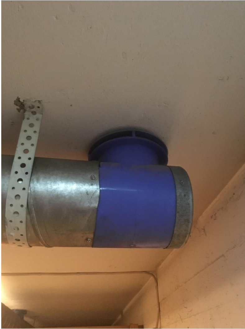
Kuva 3. Tuloilmaventtiili TV-3 asennettuna.
