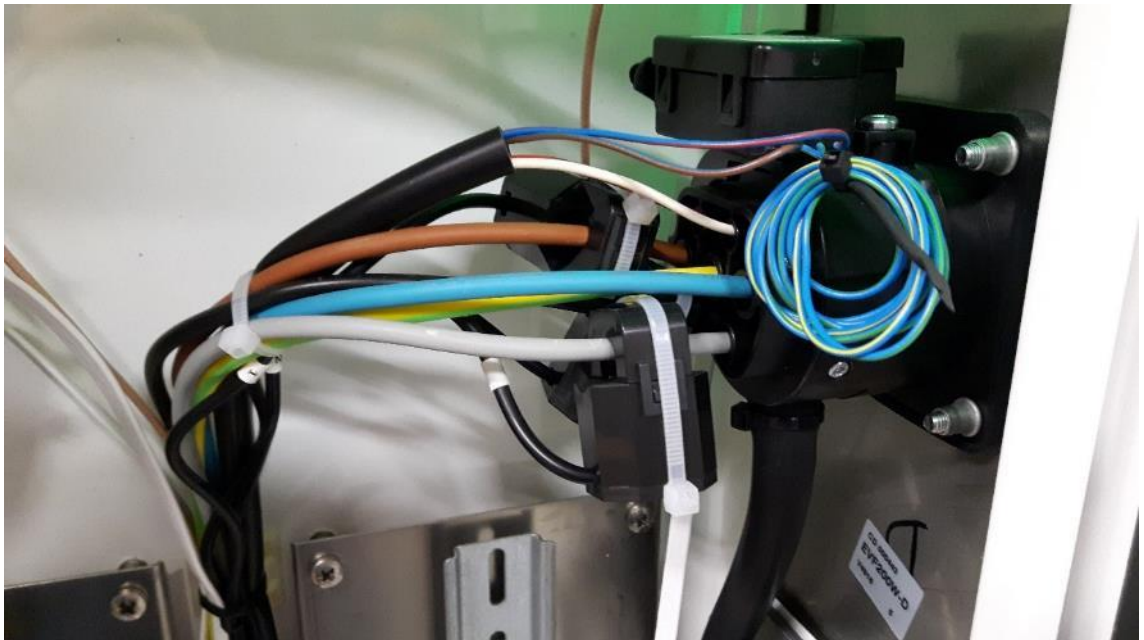
Kuva 16. Latausaseman latausvirran pihtivirtamittarit.
