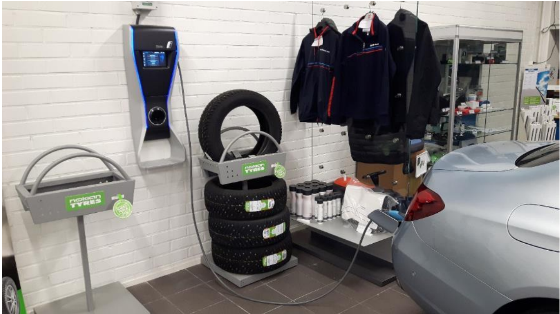
Kuva 12. Sähköajoneuvon latausasema Espoon MetroAuton tiloissa.
