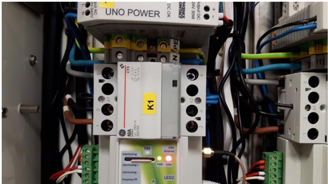
Kuva 17. Kontaktori Enston valmistaman latausaseman sisällä.
