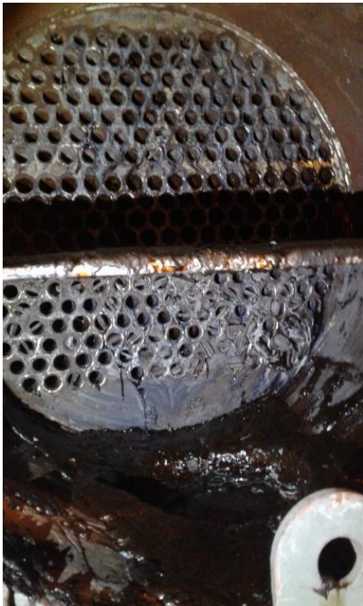
KUVA 11. Paisuntalipeänjäähdyttimen putket avatusta päädyistä katsottuna
