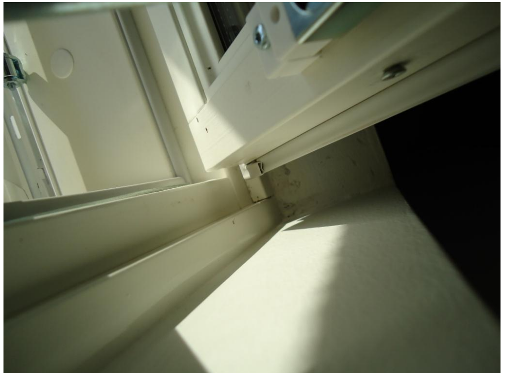
Kuva 18, Tuuletusikkunan tiivisteiden jatkos tiivisteiden päällä
