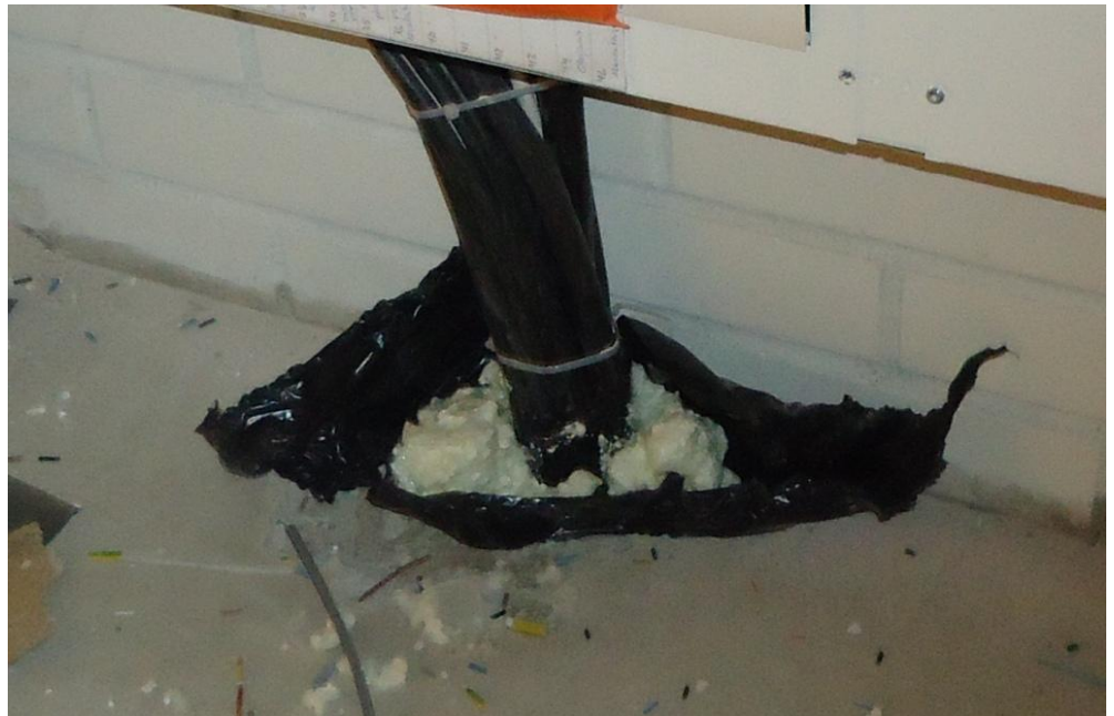
Kuva 15, Sähköläpiviennin väliaikainen tiivistys
