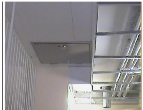
Kuva 19, Paikannettu ilmavuoto yläpohjan luukussa /27./
