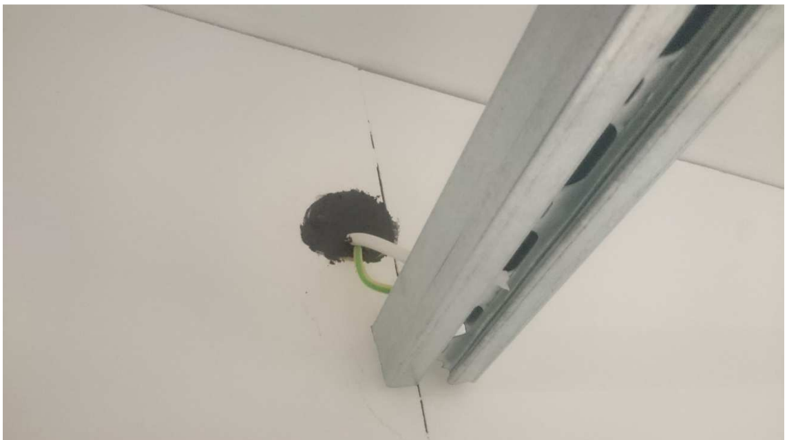
Kuva 25. Sähköläpivienti seinän läpi
