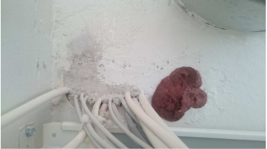
Kuva 2. Sähköläpivienti seinän läpi
