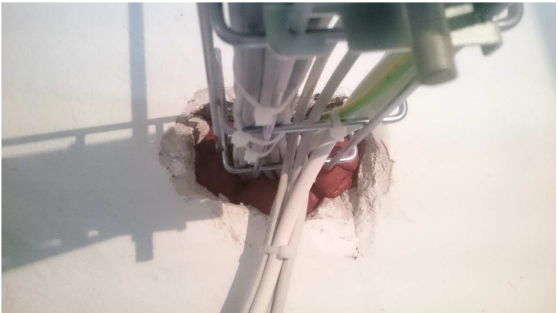
Kuva 12. Sähköläpivienti seinän läpi
