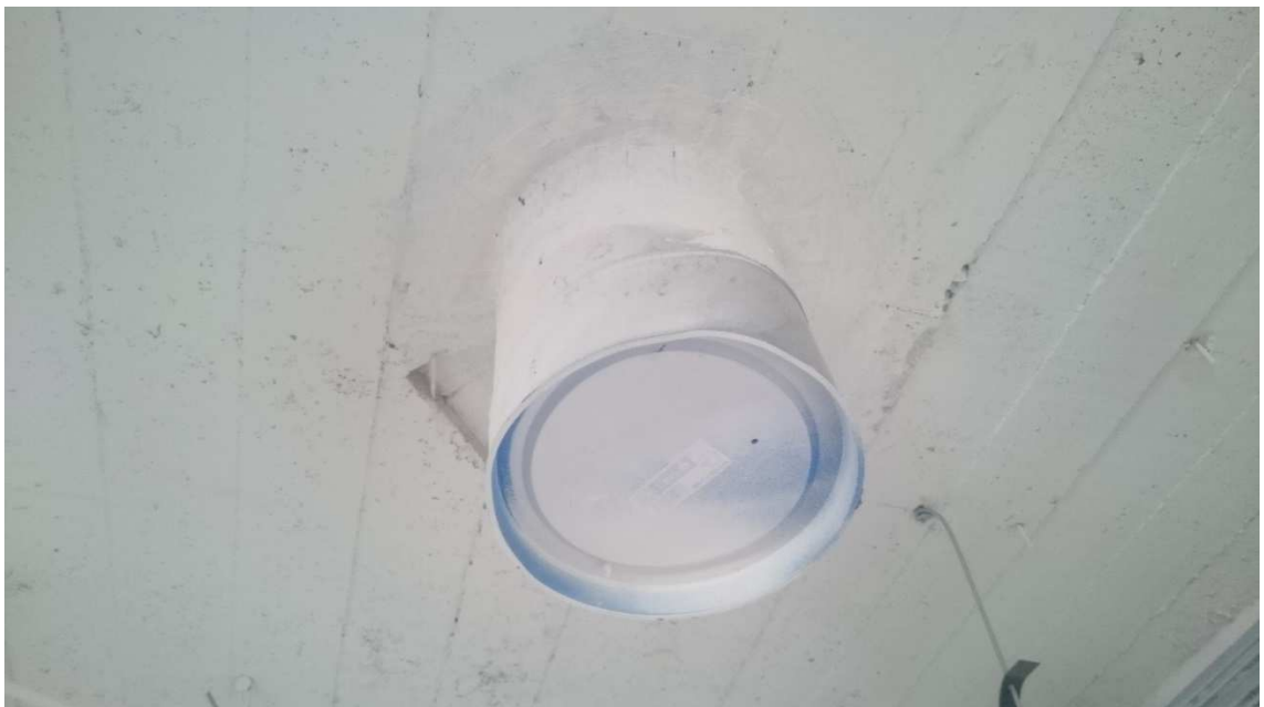
Kuva 6. Ilmastointiläpivienti välikaton puolelle
