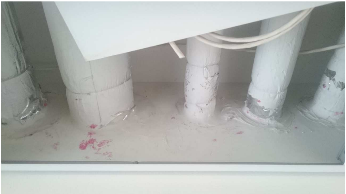
Kuva 20. Patterilinjäläpiviennit seinän läpi
