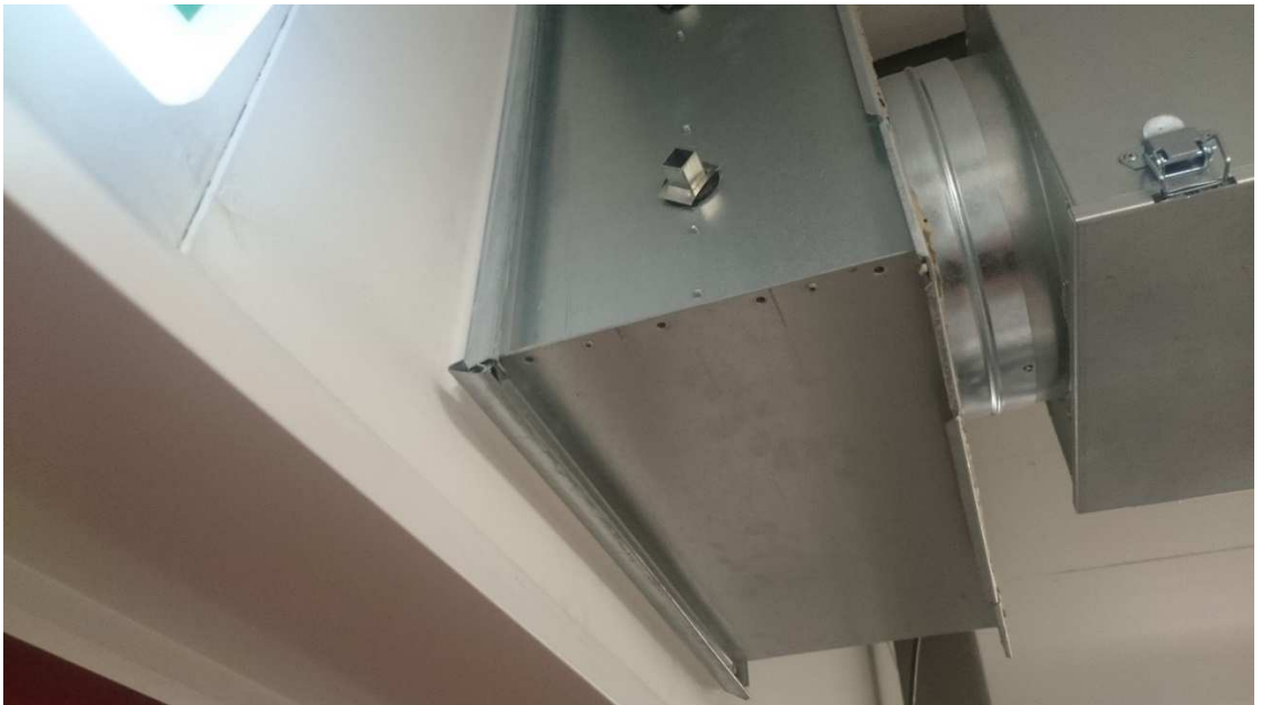
Kuva 23. Poistolimakanava seinän läpi
