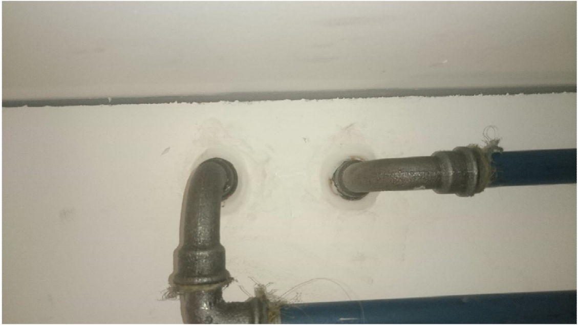
Kuva 26. Patterilinjaläpivienti lattian läpi
