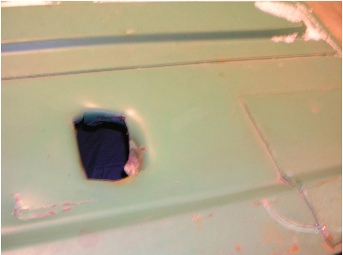
(Kuva 4. Karan aiheuttama reikä kontin katossa)
