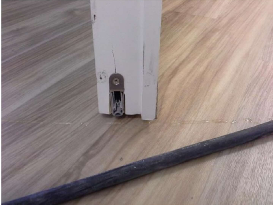
Kuva 6. Oven alareuna turvonnut
