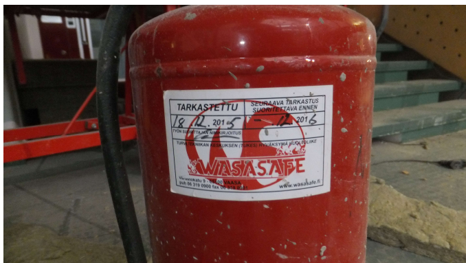
Figur 12. Granskningsmärke på pulversläckare (TR-mätning v.44, Mäenpää Rakennus Oy). Brandsläckare granskas minst en gång om året.
