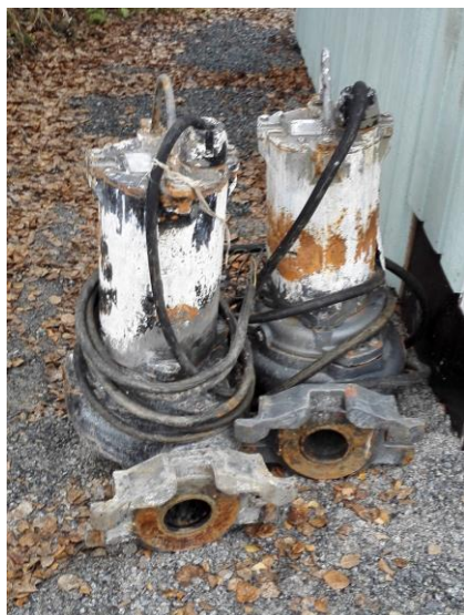
Kuva 5. Jätevesipumppaamon vanhat pumput
