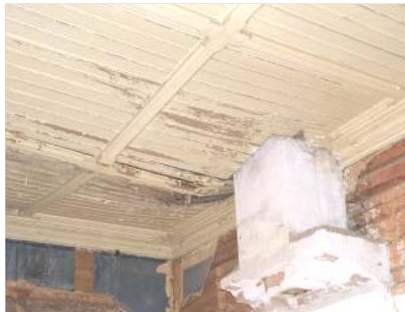
Kuva 8. Matkatavaratilan kattopinta ennen korjaustöitä. (Maijanen 2009)
