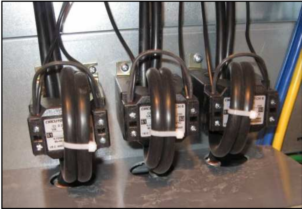
KUVA 1 Esimerkkikohteen pääkeskuksessa käytettävät virtamuuntajat /12/.
