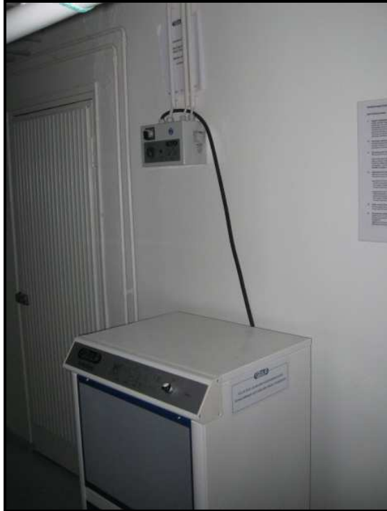
KUVA 17 Pyykkituvan Esterin keskus- ja ohjausyksikkö /12/.
