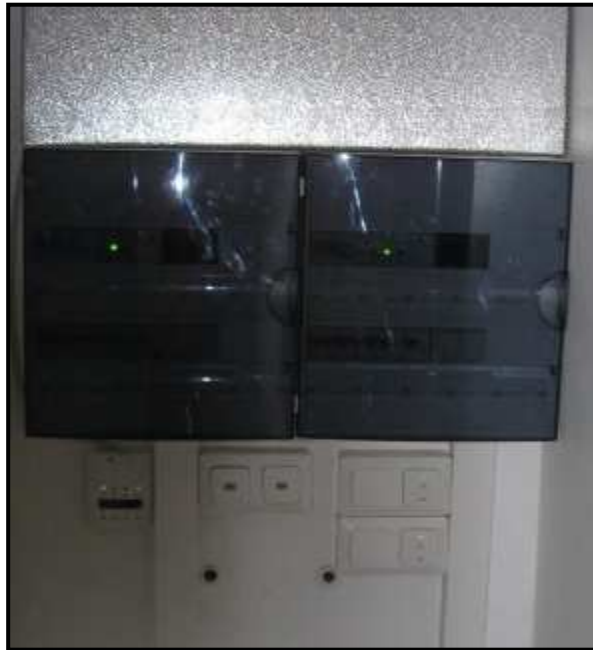
KUVA 19 Saunojen keskukset, ilmastoinnin ohjaus ja siivouspainonapit /12/.
