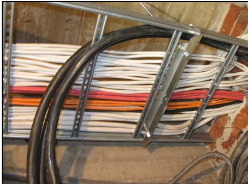
KUVA 5 PK -tilan kaapelointi /12/.
