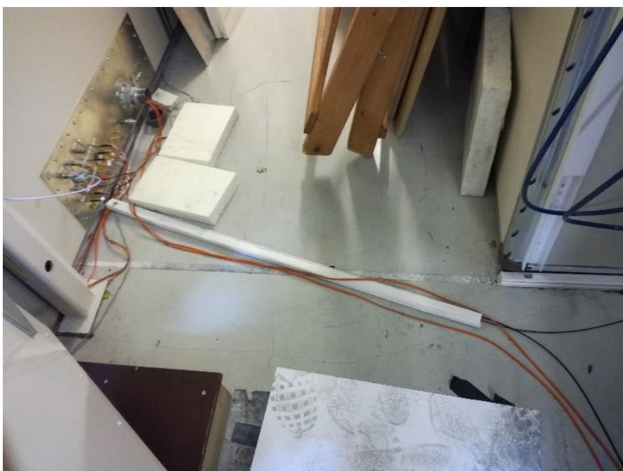
Kuva 6. SAC valokuitukaapelien läpivienti
