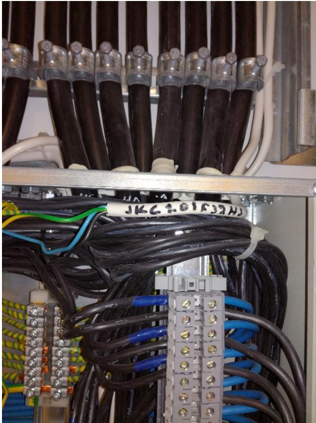
Kuva 13. Häätä-seispiirin ryhmäkaapeli JKC1.01F32HS
