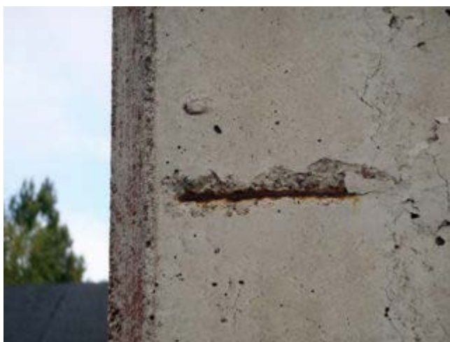
KUVA 3. Betonin vaurioituminen (betoni.com, 2017)
