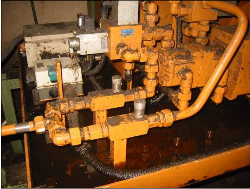
Kuva 7. Hydraulikkakoneikon alla olevassa kaukalossa on öljyä
