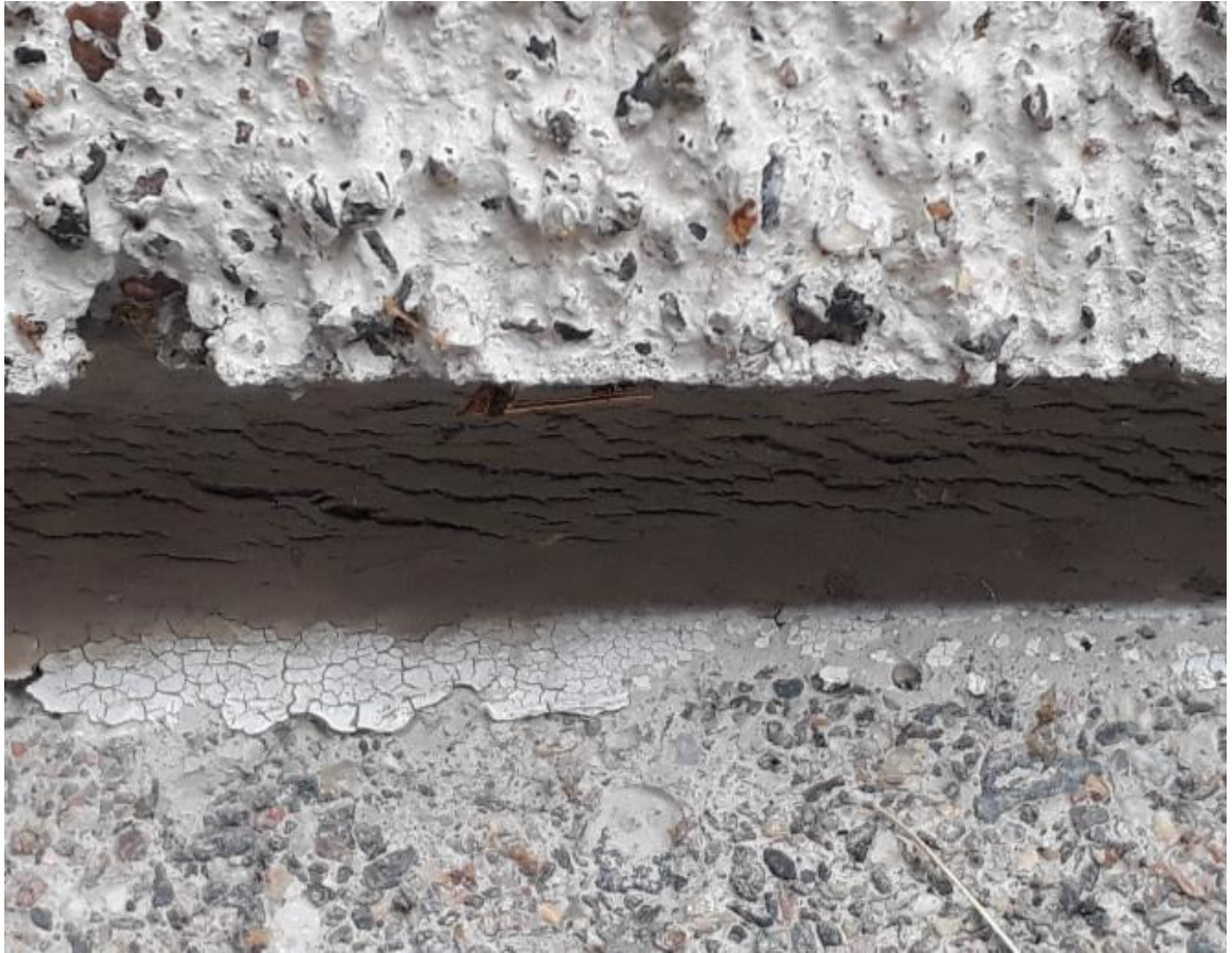
KUVA 10. Osa kohteen 8 elementtisaumaa, jossa näkyy selkeitä halkeamia ja rappautuneisuutta
