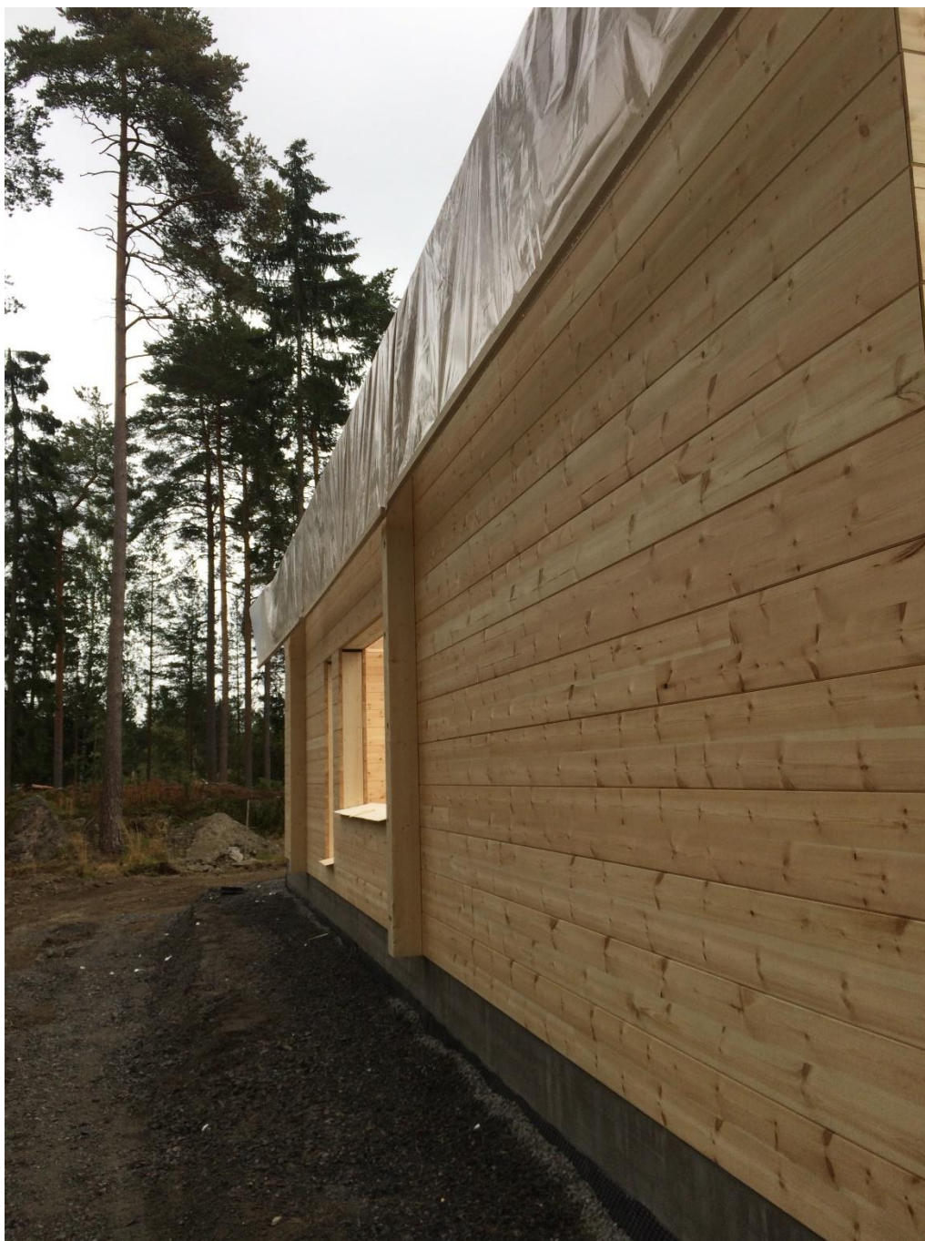
Kuva 5. Kosteudenhallinta toteutettu kallistamalla vaneri rakennuksen seinästä ulospäin ja ympäröimällä se muovilla. Muovin tulee ylittää tarpeeksi pitkälle, jotta myös seinät ovat suojassa. (Musakka 2017-04-09)
