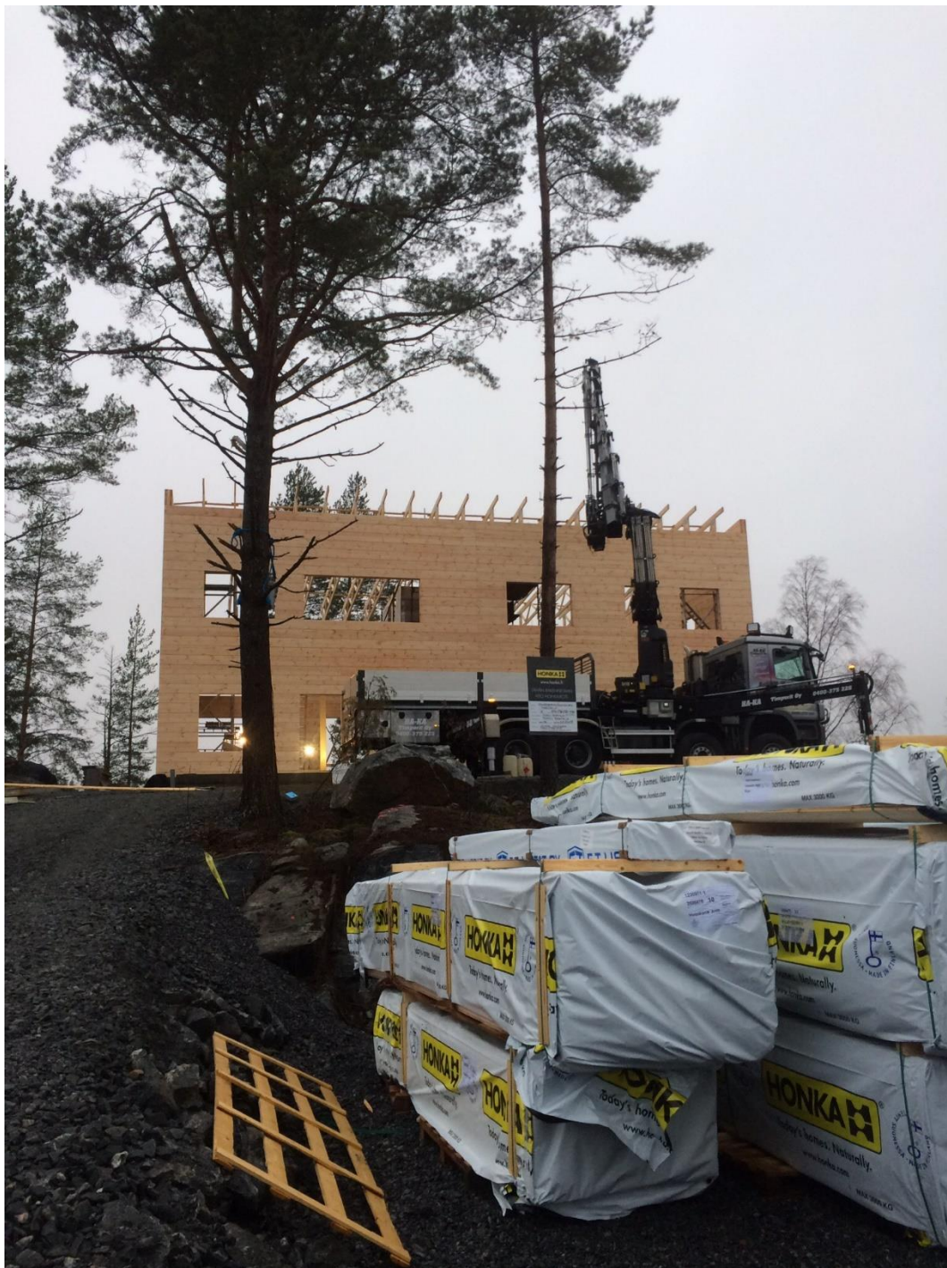
Kuva 16. Juoksumetri- ja kappaletavaramateriaalia sisältävät pakkaukset voidaan ahtaalla työmaalla sijoittaa hirsiasennuksen ajaksi päällekkäin (Musakka 2016-11-11)
