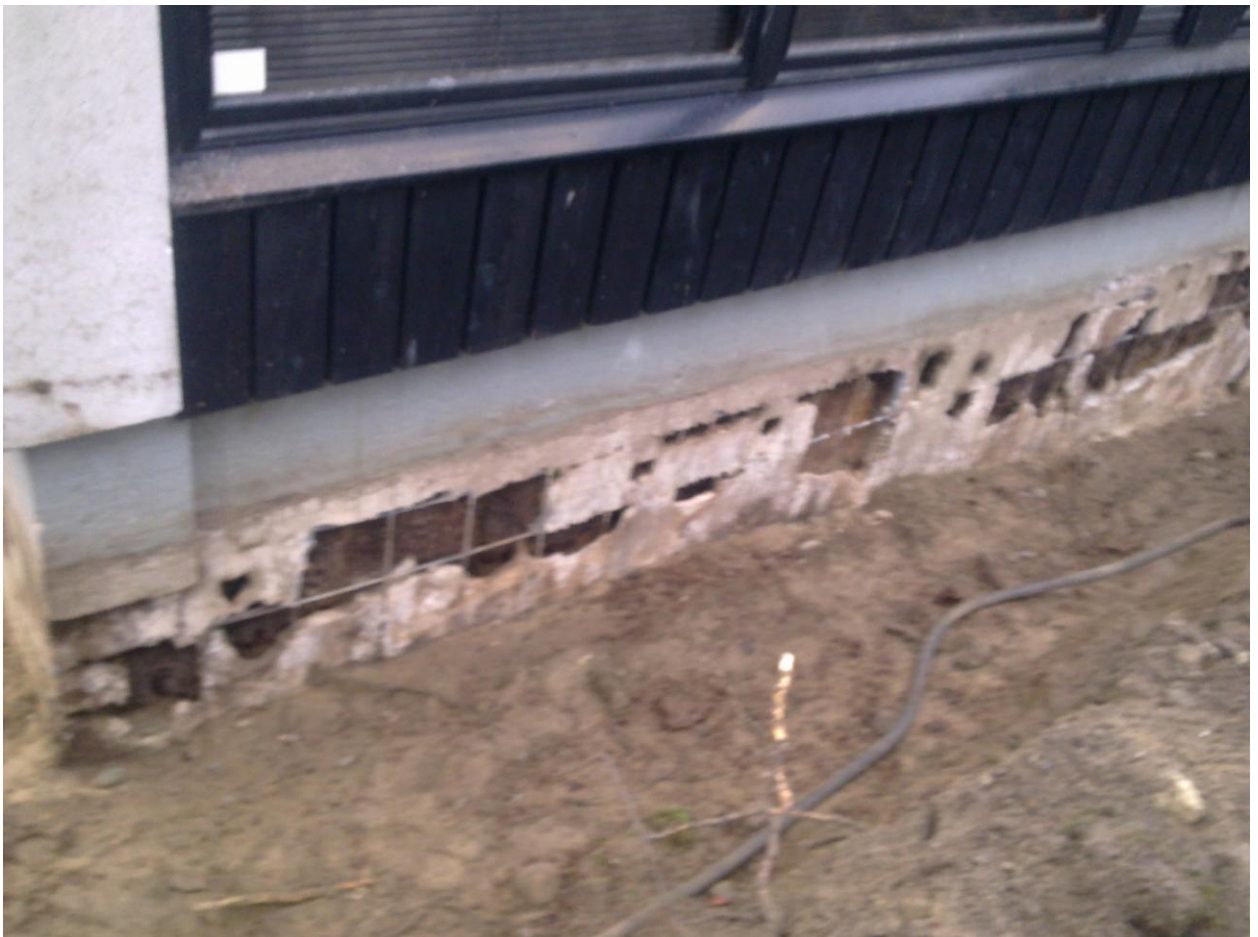
Kuva 13. Pahasti vaurioitunut sokkeli
