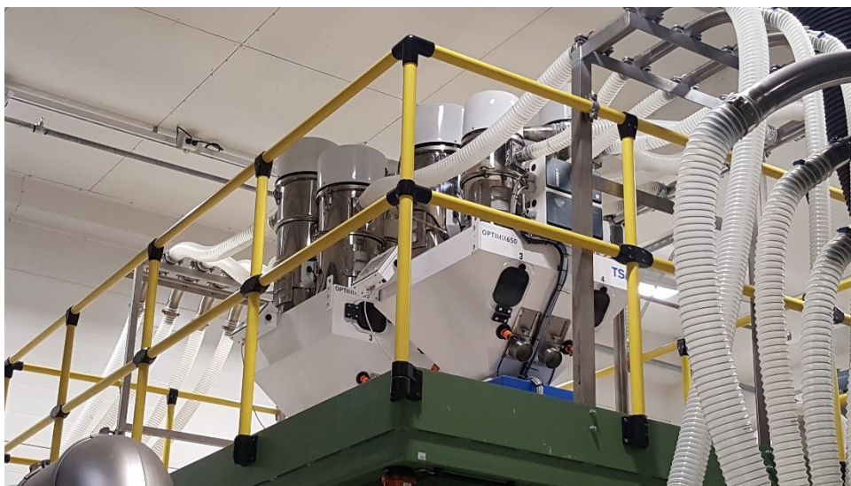
Kuva 12. Ekstruuderin muovinsyöttölaitteisto imuputkineen.
