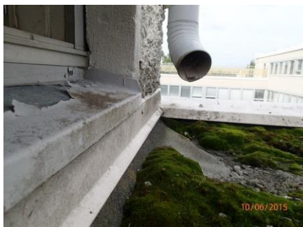
Kuva 25 Katon sijoittuminen ikkunan lähelle lisää kosteudelle altistumisen riskiä (Sisäilmaraportti).
