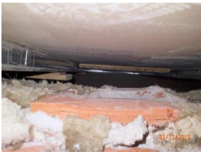
Kuva 2 Myöhemmin tehdyssä muutos- ja purkutöissä on jätetty osittain eristeitä levyseinän taakse (Sisäilmaraportti).
