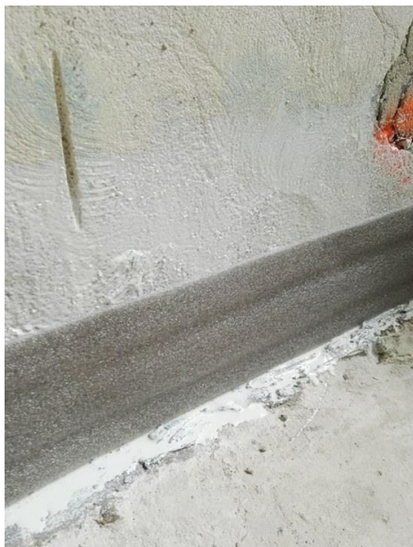
Kuva 13 Uuden lattian pintavalun irroituskasta liimattiin kiinni ylimääräisten reikien ehkäisemiseksi valmiiseen tiivistuspintaan (Juvonen 2017).
