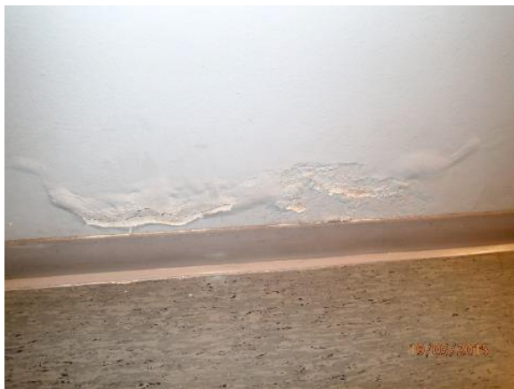
Kuva 21 Kellarin väliseinän alaosan kosteusvaurio. (Sisäilmaraportti)
