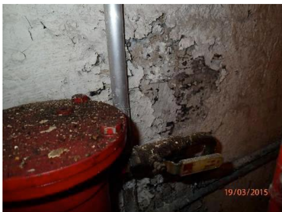
Kuva 22 Kellarin maanpaineseinän kosteusvaurio. (Sisäilmaraportti)
