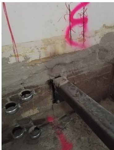
Kuva 10 Ulkoseinän kapselointi aloitetaan alhaalta asti jo ennen uutta lattiarakennetta. Kuvassa pohja ennen tiivistystä (Juvonen 2017).
