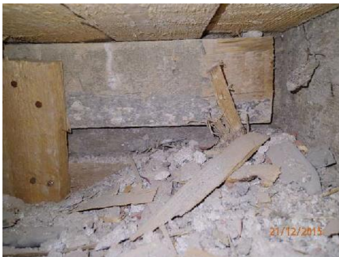
Kuva 15 Kuva avatun ripalaataston sisältä. Kuvasta voidaan huomata vanha muottilauδοitus välikeroksessa (sisäilmaraportit).
