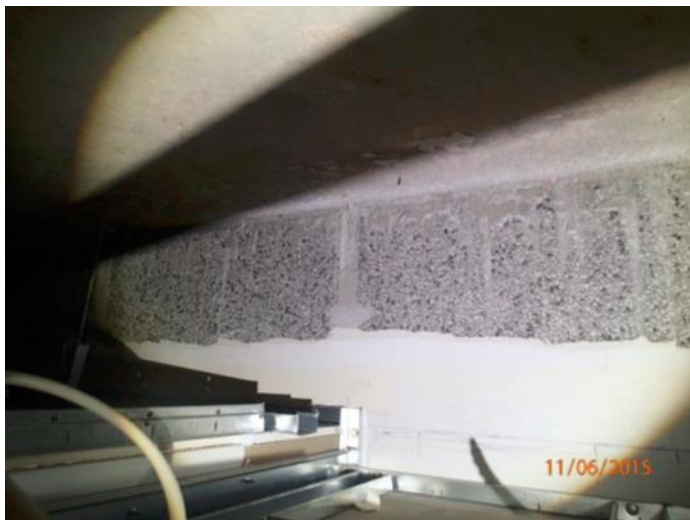
Kuva 3 Alakattotilaa tarkasteltaessa huomattiin vanhan seinän julkisivuverhous, joka oli vielä paikallaan (Sisäilmaraaportti).
