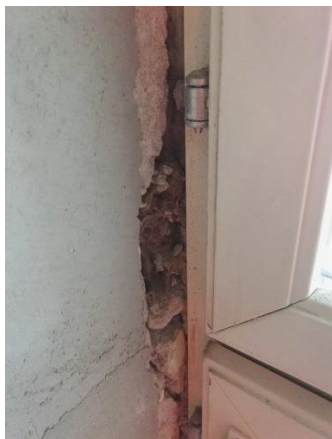
Kuva 28 Vanhojen ikkunoiden piilien rappauspinnat olivat hauraat (Juvonen 2017).
