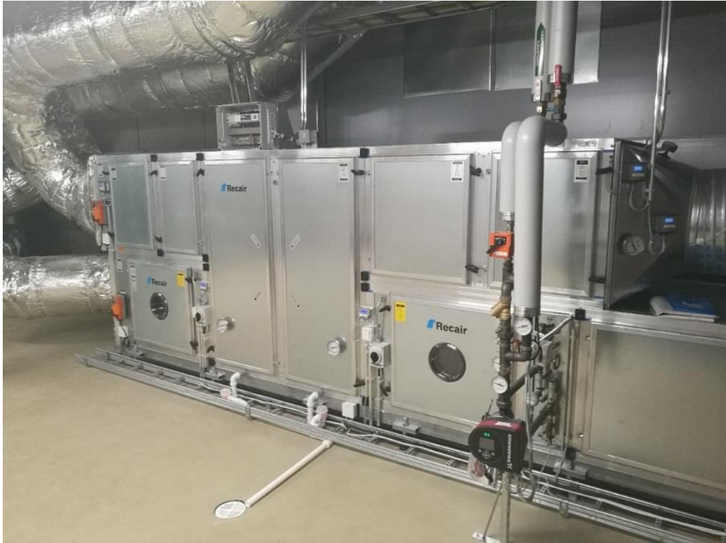
Kuvio 21. Ilmanvaihtokone kalustettuna ja kytkettynä
