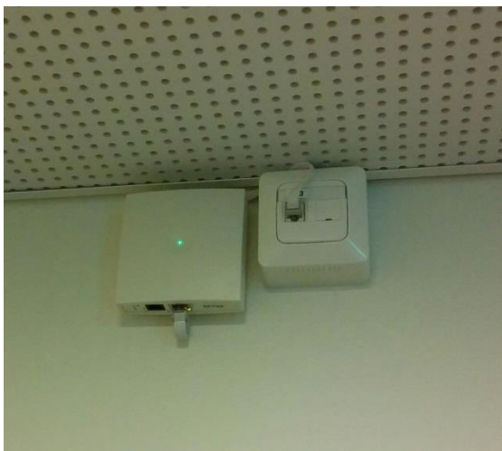
KUVA 22. Ip-tukiasema asennettuna katonrajaan
