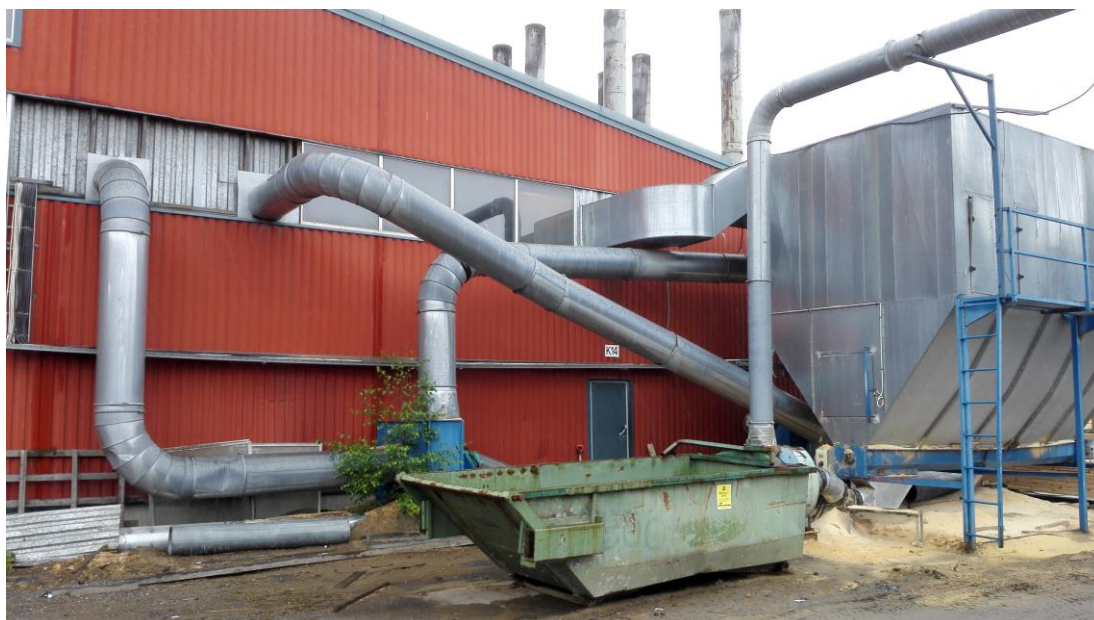
Kuva 4. Suodatin, tuloputket, poistoputki, paluuilmanakanava sekä suodattimen ympäristöön kerääntynyttä sivutuotetta.
