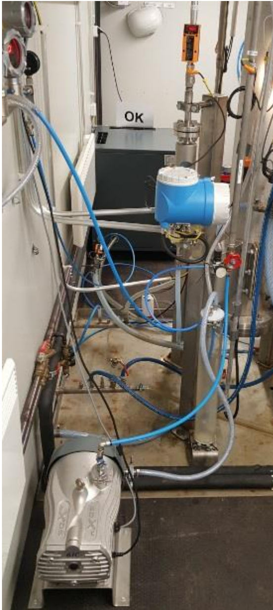
Kuva 16. Pilot-prosessin alipainepumppu ja tuotekaasulinja
