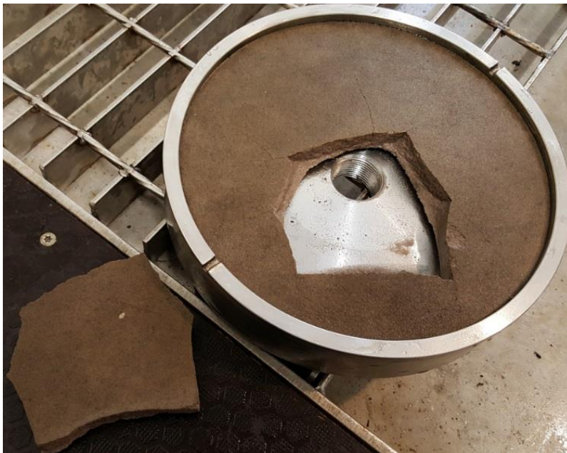
Kuva 21. Testikäytössä (2 kk) rikkoutunut hienokeraaminen kaasuhajotin
