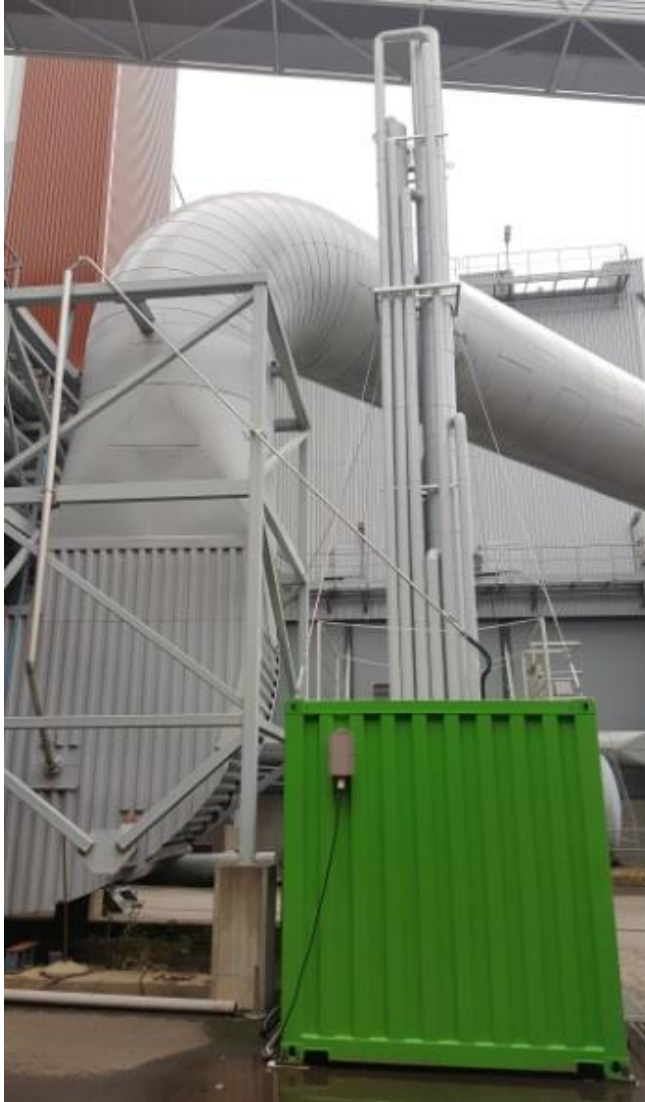
Kuva 14. Pilot-kontti ja savukaasun tuloputki Pääskylahden voimalaitoksella
