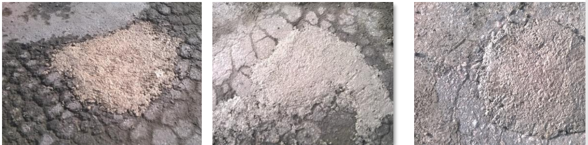
KUVA 16. KOHDE 2 VAURIOKOHTIEN PAIKKAUKSIA HETI PAIKKAUKSEN JÄLKEEN.
