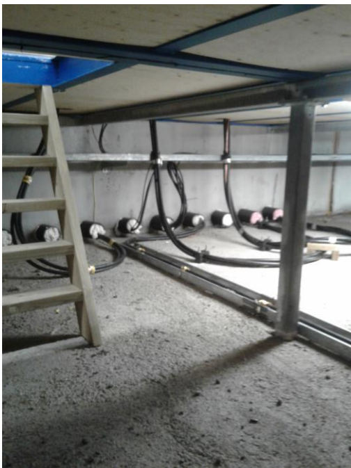
Figur 3: En bild inne på en kabelkällare.
