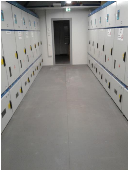
Figur 2: Inne på en elstation.
