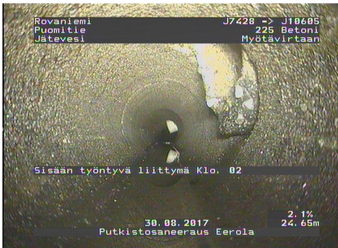
Kuvio 2. Videokuvaus betoniviemärin sisällä (Napapiirin Vesi Oy 2017a)
