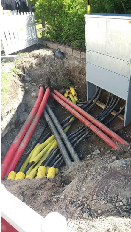
Kuva 3. Jakokaappi ja maakaapelointi Vantaan Tikkurilassa VES:n työmaalla.
