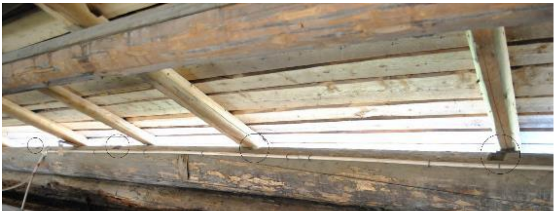
Kuva 13. Nykyään pärekattoisen rakennuksen seinän ylimmästä hirrestä löytyi räystäskoukkujen kolot, jotka kuvassa ympyröity.
