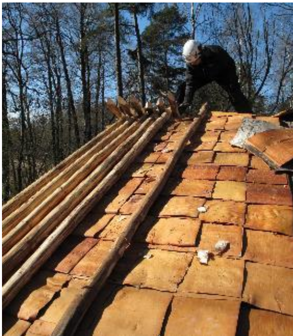
Kuva 23. Malkojen asettelua tuohien päälle räystääslankullisessa katossa. Joskus malkojen ristämiskohdan ohennusta voidaan vielä veistää katolla, jotta malat asettuvat toisiaan vasten.
