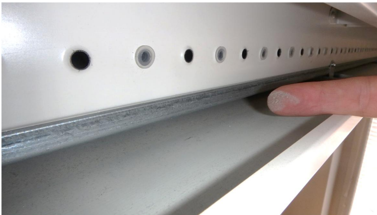
Kuva 53. Toimistorakennuksen tuloilmakanaviston jäähdytinpalkkien alapuolisen suojalevyn pinta ei silmämääräisesti arvioituna näytä kovinkaan likaiselta, mutta jo pienikin pyyhkäisy sormella tuo levyn pölyisyyden esille. [Kuvan lähde: IdeaStructura Oy.]
