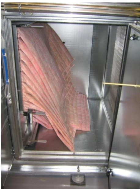
Kuva 47. Vaakasuuntaan asennettuna suodatinpussit eivät välttämättä aukea kunnolla ilmavirrasta huolimatta, ja pahimmillaan ne voivat maata suodatinkammion pohjalla ja kastua, kun ilmanvaihtokone käy pienellä teholla. Tämä taas luo edellytykset mikrobikasvulle suodattimessa, ja mikrobien leviämiselle ilmanvaihtoon. [Kuvan lähde: IV-kuntotutkimusohjeet 2016, ohje 14: 9.]
