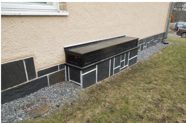
Kuva 43. Erään koulurakennuksen tuloilmakammion sijoitus.
