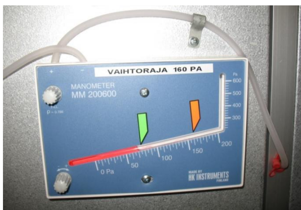
Kuva 46. Ilmanvaihtokoneen suodattimen painehäviön mittauslaite. Kuvan ilmanvaihtolaitteen suodatin on vielä kunnossa. [kuvan lähde: IV-kuntotutkimusohjeet 2016, ohje 14: 9.]
