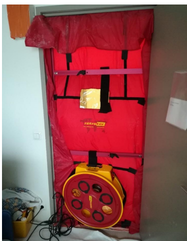
Kuva 71. Rakennuksen alipaineistukseen soveltuva puhallinlaitteisto asennettuna erään koulu- luokan välioveen. [Kuvan lähde: IdeaStructura Oy.]
