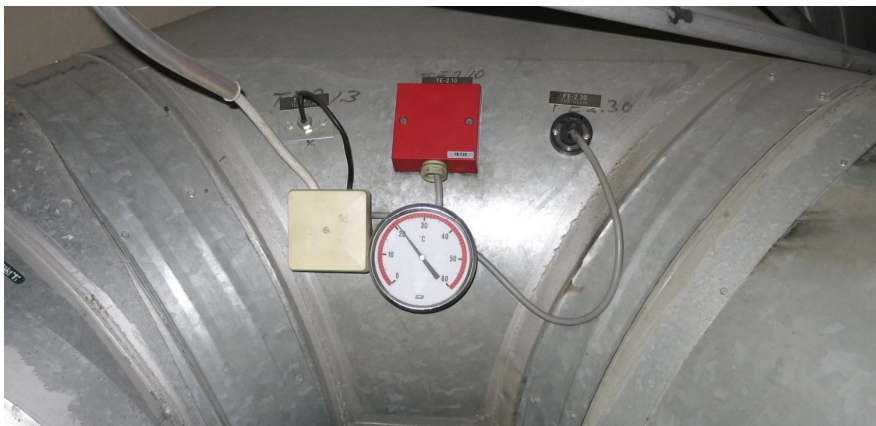
Kuva 69. Tuloilman lämpötilaa voidaan tarkastella ilmanvaihtokanaviston lämpömittareista. Kuvassa on erään kirjaston tiloja palvelevan ilmanvaihtokoneelta lähtevän tuloilmakanavan lämpömittari. Kuvasajankohtana tuloilman lämpötila oli noin +21^{\circ}\text{C} , jota pidettiin liian lämpimänä. [Kuvan lähde: IdeaStructura Oy.]
