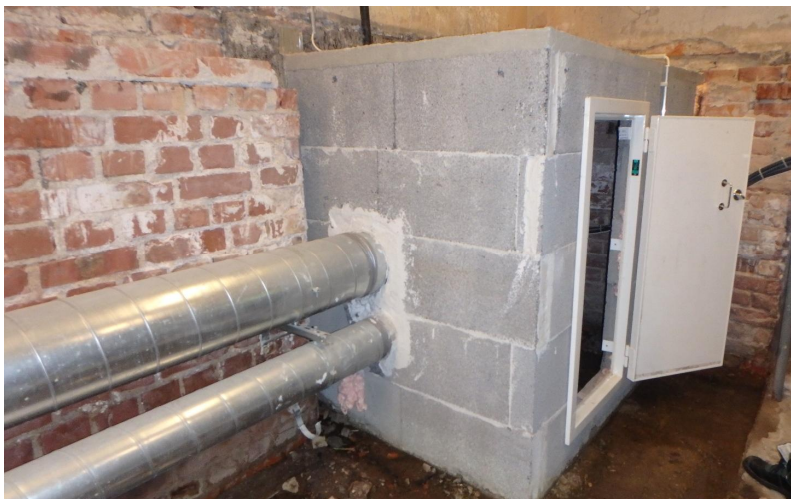
Kuva 42. Erään koulurakennuksen kevytsoraharkoista muurattu poistoilmakammio. [Kuvan lähde: IdeaStructura Oy]
