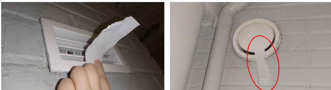
Kuva 54. Ilmanvaihtojärjestelmän toimintaa voidaan selvittää aistinvaraisesti esimerkiksi paperipalan avulla. Vasemmassa kuvassa on tuloilmakanava, jonka kautta havaittiin selkeästi tuloilmavirta (paperinpala taipui ilmavirran mukana). Oikealla on poistoilmakanava, joka myös oli toiminnassa (paperinpala pysyi itsestään kiinni poistoilmakanavassa). [Kuvan lähde: IdeaStructura Oy.]
