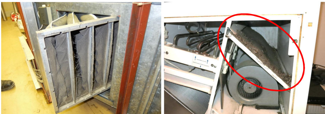
Kuva 45. Vasemmalla erään terveysaseman ilmanvaihtokoneen tuloilmasuodattimet, kuvan karkeasuodatin on erityisen likainen ja vaihdon tarpeessa. Oikealla olevassa kuvassa on erään toimistorakennuksen ilmanvaihtokoneen tuloilman esisuodatinmatto, joka on jo kokonaan tukkeutunut. [Kuvan lähde: IdeaStructura Oy.]
