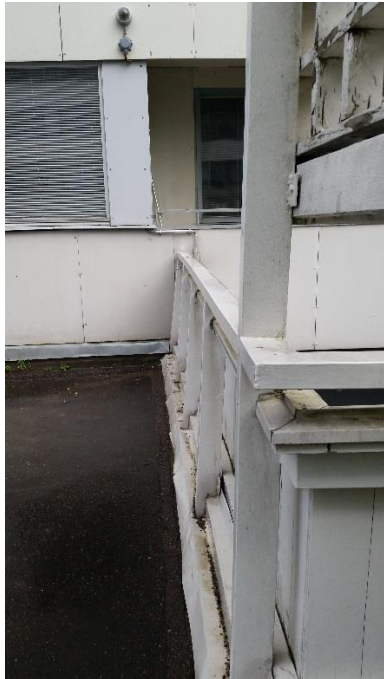
Kuva 5. Parkkikannen vanhankaiteen vinous kuvattu ennen töiden aloitusta, kaiteelle ei toimenpiteitä urakassa.
