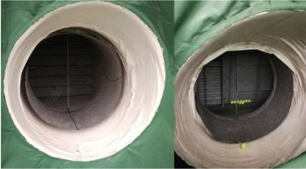
KUVA 17. Ylipainehallin poistoilma-aukko vasemmalla ja tuloilma-aukko oikealla
