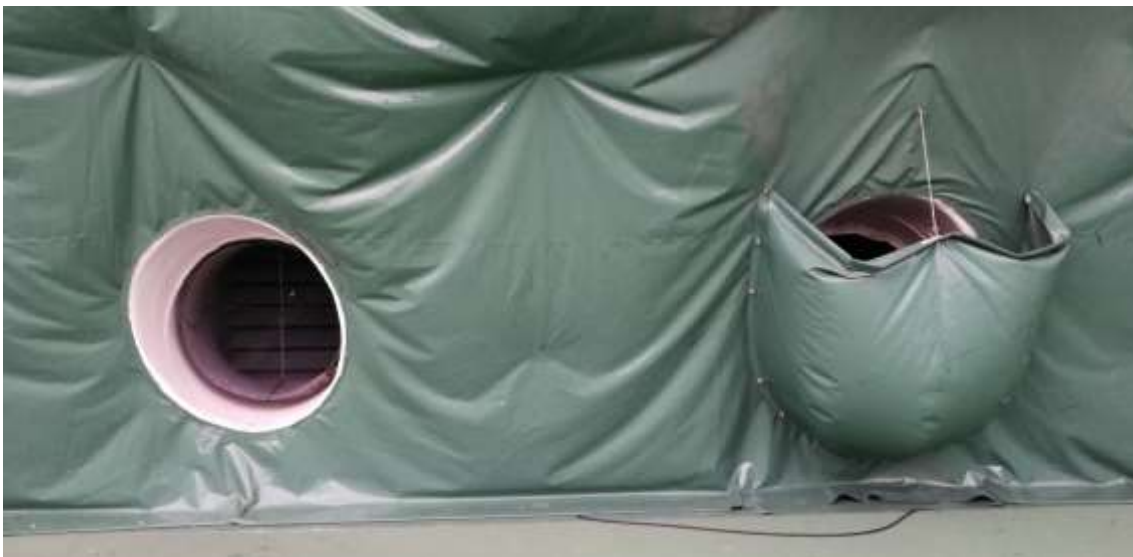
KUVA 18. Ylipainehallin tulo- ja poistoilma-aukko
