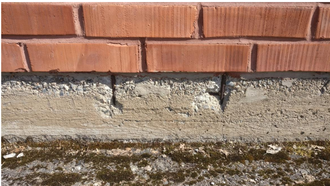
Kuva 3, sokkelin raudoitukset näkyvissä ja ruosteessa. Suojabetonipaksuus jäänyt liian pieneksi.
