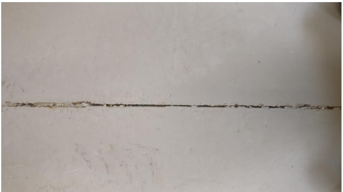
Kuva 6, paloautohallin liikuntasauvojen puutteelliset massaukset.
