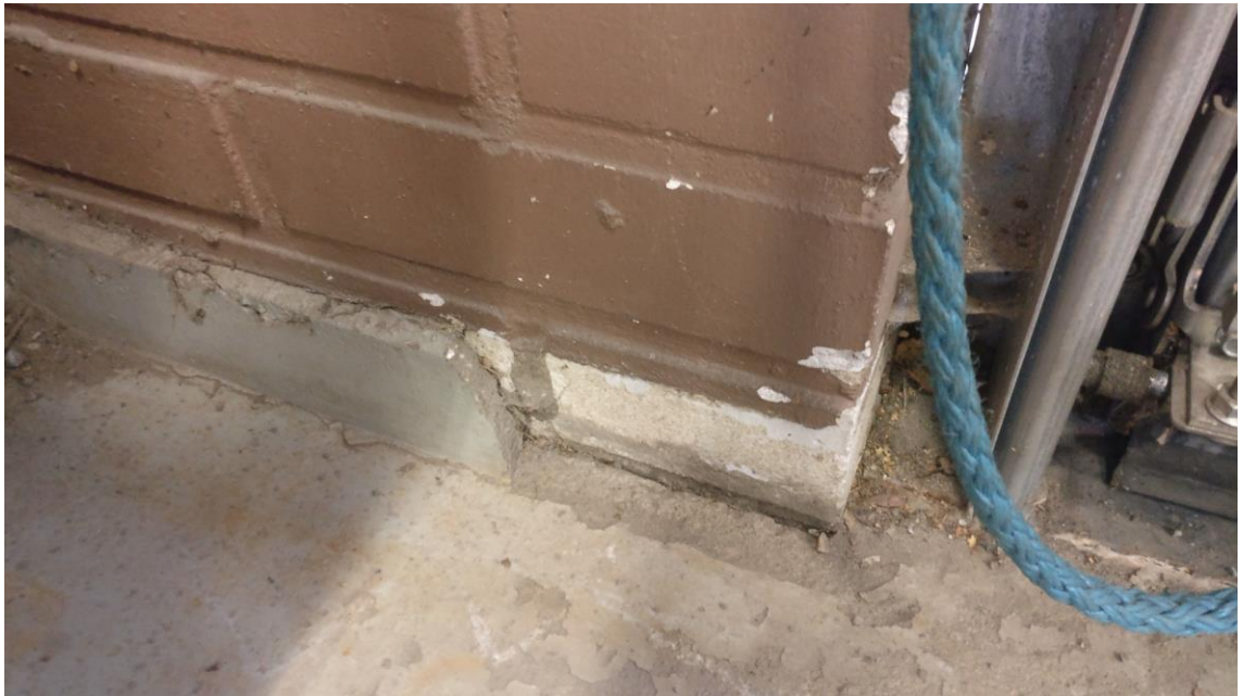
Kuva 7, pakettiauto-traktoritallin haljennut betonijalkalista.
