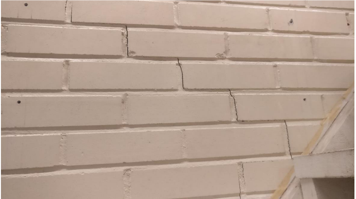
Kuva 8, paloautohallin sisäpuolisen tiiliseinän muurauksien halkeama.
