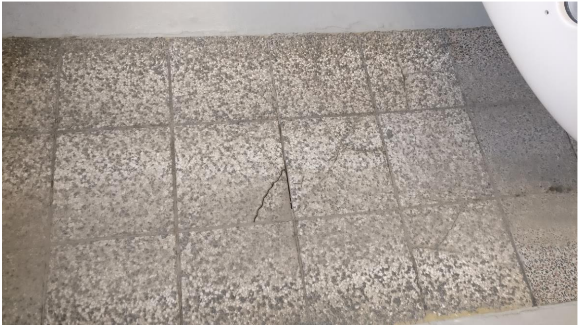
Kuva 5, paloautohallin ajourien haljenneita laattoja.
