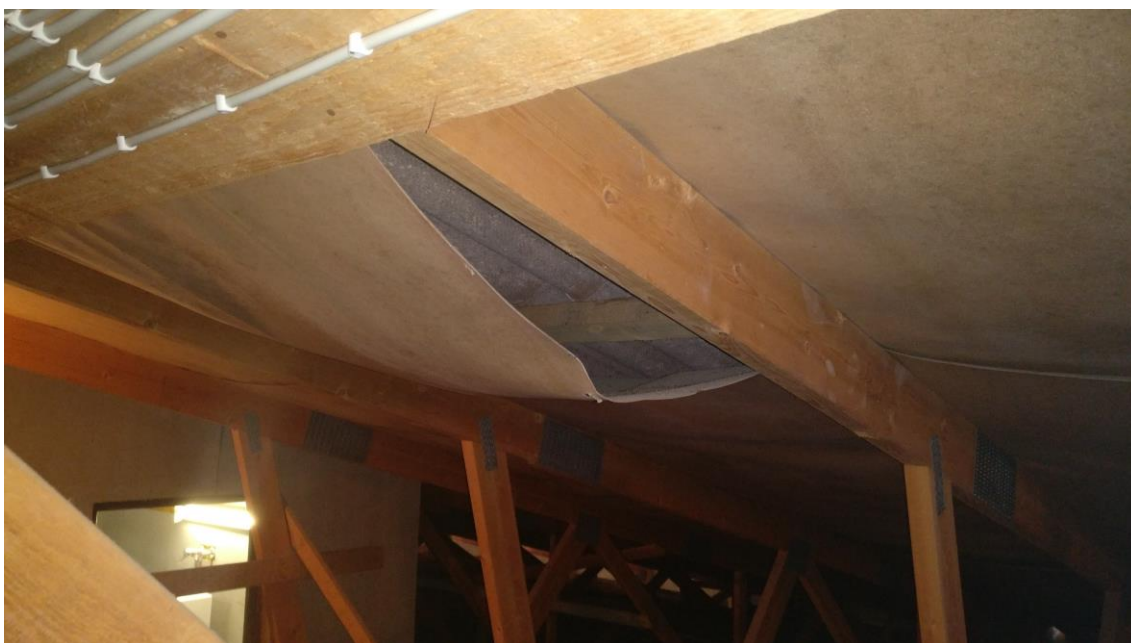
Kuva 12, vesikattorakenteen roikkuvia panssarialuskatteita.
