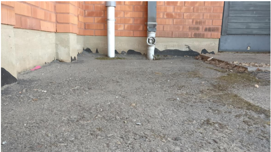
Kuva 1, rakennuksen länsipuolella puutteellinen kallistus ja sammaloitumista.
