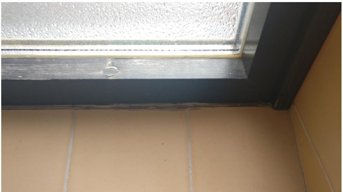
Kuva 21, Ikkunapenkin ja ikkunan karmin välinen rako.
