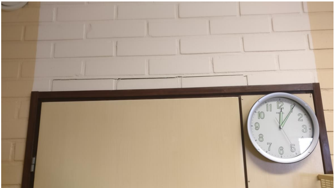
Kuva 17, palopäällikön huoneen välioven yläpuolen murtuma.
