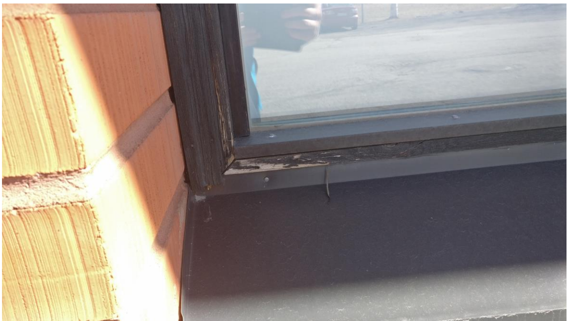
Kuva 10, ikkunan listojen haalistunutta ja hilseilyttä maalipintaa.
