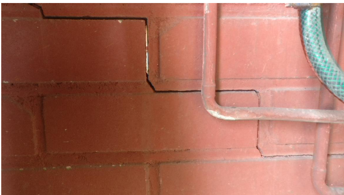
Kuva 15, pesuhallin ja paloautohallin väliseinän muurauksien halkeama.
