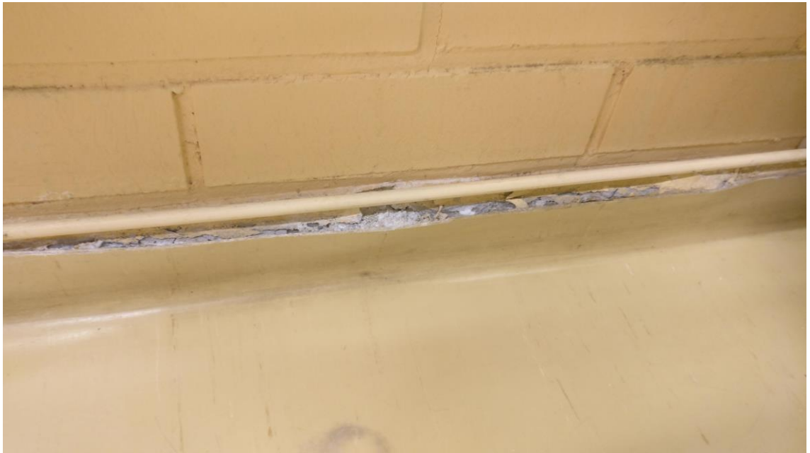
Kuva 24, kosteuden aiheuttamia pullistumia muovimatossa.
