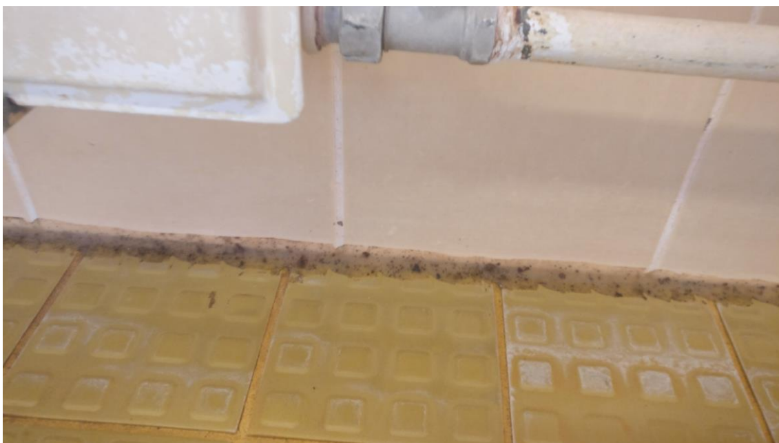
Kuva 23, pesuhuoneen lattian ja seinän silikonisaumat huonokuntoiset.
