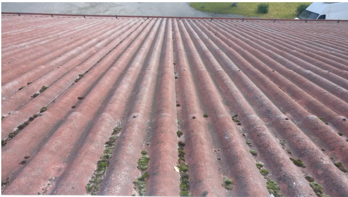
Kuva 11, varttikatteen kulunut pinta, sammalkasvustoa sekä nousseet kiinnikkeet.
