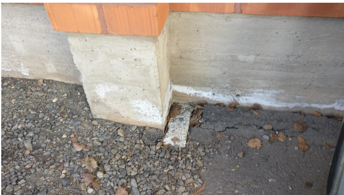
Kuva 4, liiallinen kosteus aiheuttaa sokkeliin kalkkihärmettä.
