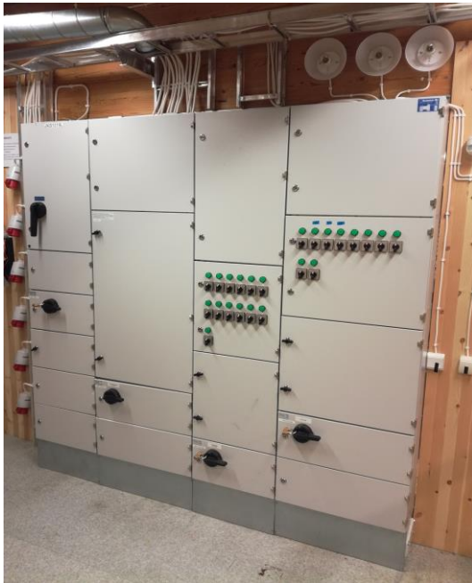
Kuva 12: Parven uusi pääkeskus.
