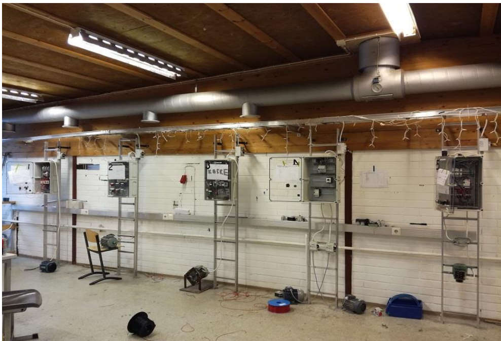
Kuva 19: Parven vanhat moottorikytkentäkeskukset
