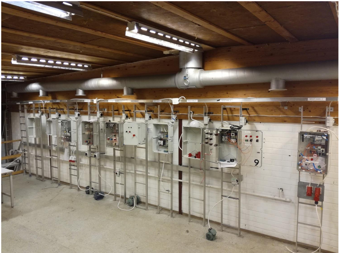
Kuva 20: Parven uudet moottorikytkentäkeskukset
